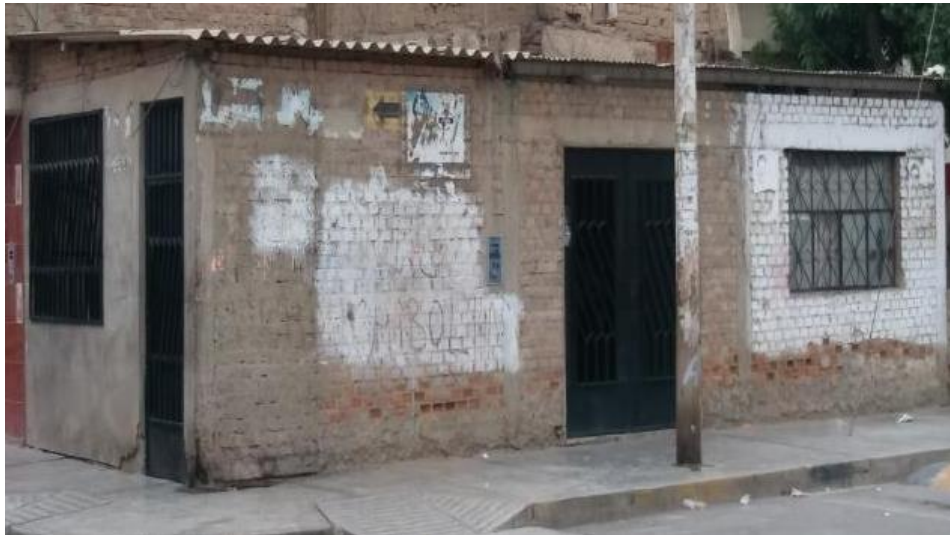
Figura 4.3. Edificación de albañilería con ladrillo artesanal con mala conexión entre sus unidades y mortero de mala calidad.
