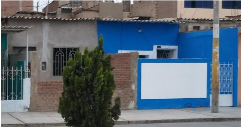
Figura 4.7. Edificaciones de albañilería con ausencia de diafragmas rígidos. Techo solo con cubierta liviana.
