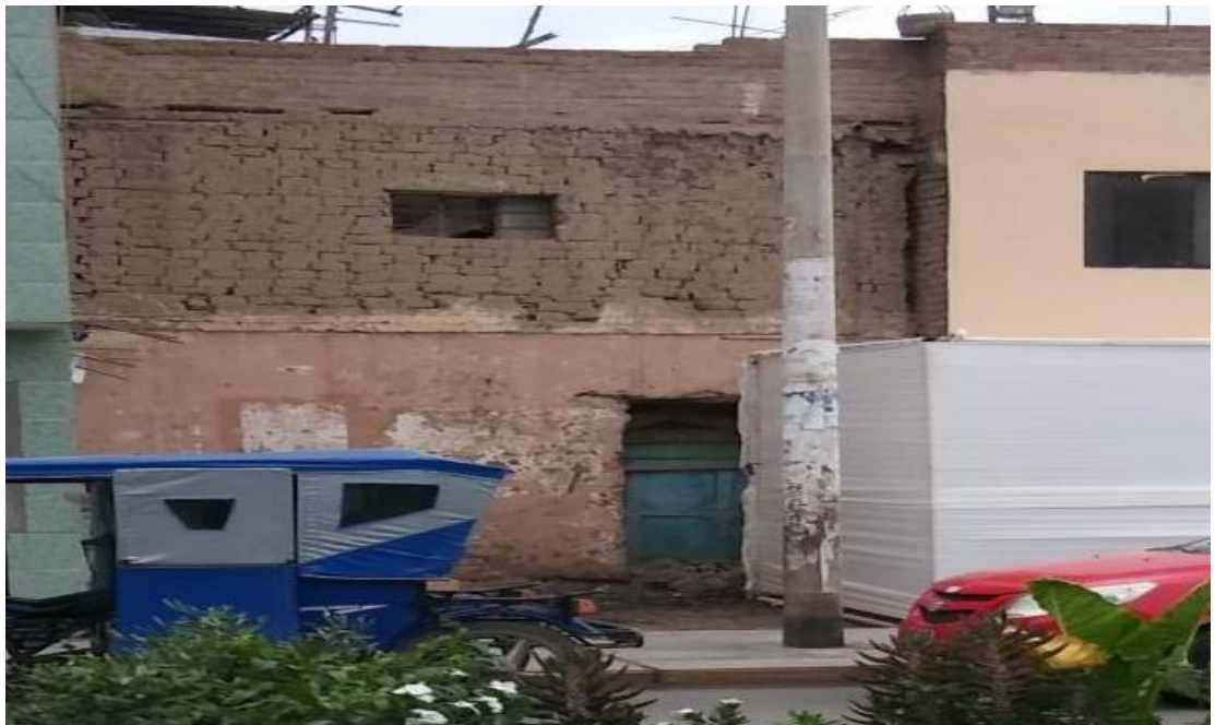
Figura 4.14. Edificación de adobe con gran deterioro en sus componentes y presencia de grietas.
