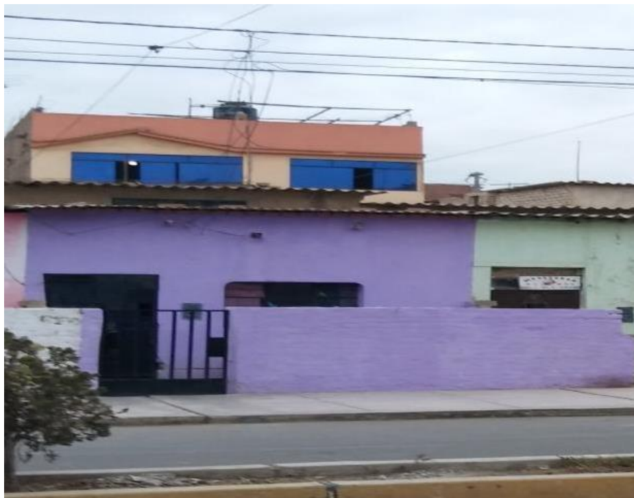
Figura 4.2. Edificación de adobe sin elementos de arriostre en sus cuatros lados
