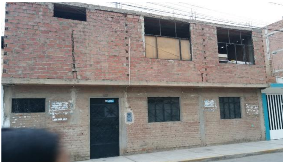
Figura 4.9. Edificación de albañilería con cambio en la calidad de los materiales.
