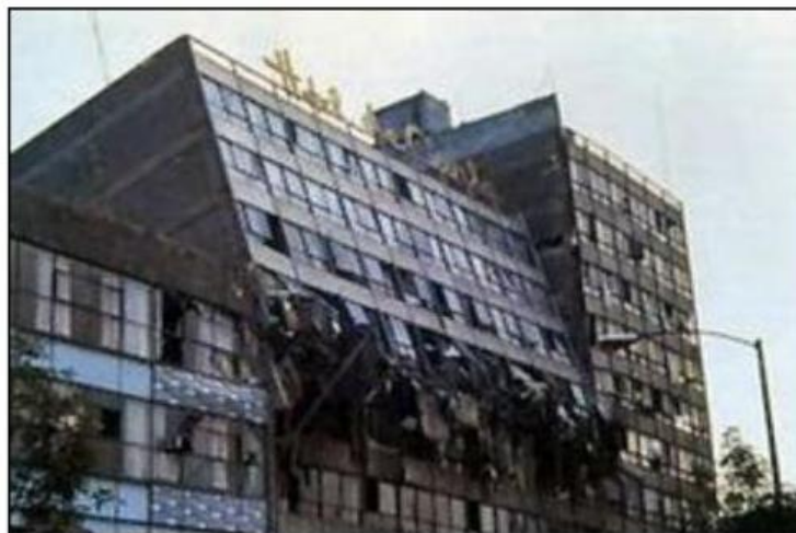
Figura 2.9. Falla por falta de juntas de separación sísmicas, sismo México 1985.
