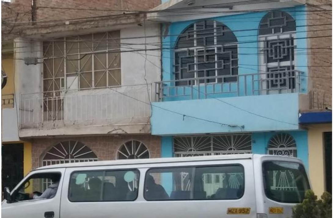
Figura 4.12. Izq: Balcón en mal estado e inestable. Der: Balcón en buen estado y aceptablemente estable.
