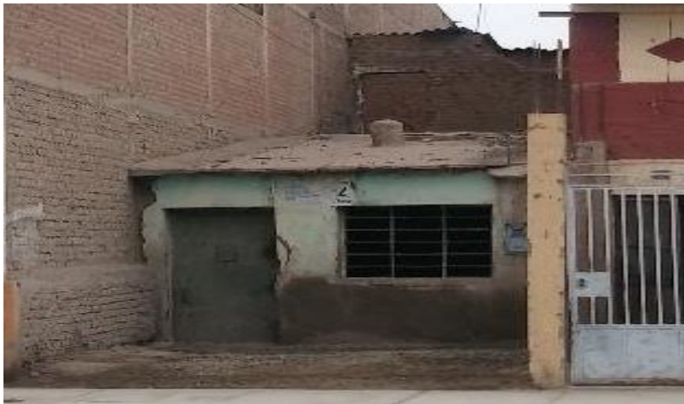
Figura 4.5. Edificación de adobe con presencia de sales y humedad. Estado de conservación deteriorado.
