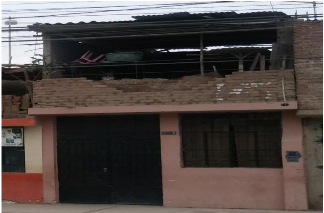
Figura 4.11. Parapetos sin elementos de confinamiento.
