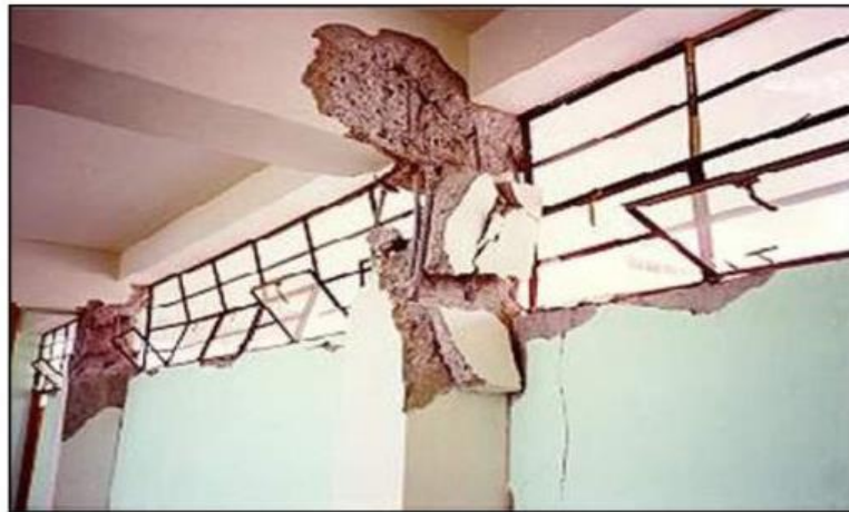
Figura 2.6. Falla por columna corta en un centro educativo de Nazca.
