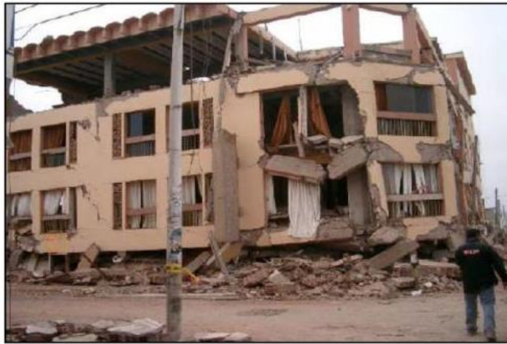
Figura 2.7. Colapso de Hotel por problema de piso blando, sismo en Pisco-Perú 2007.
