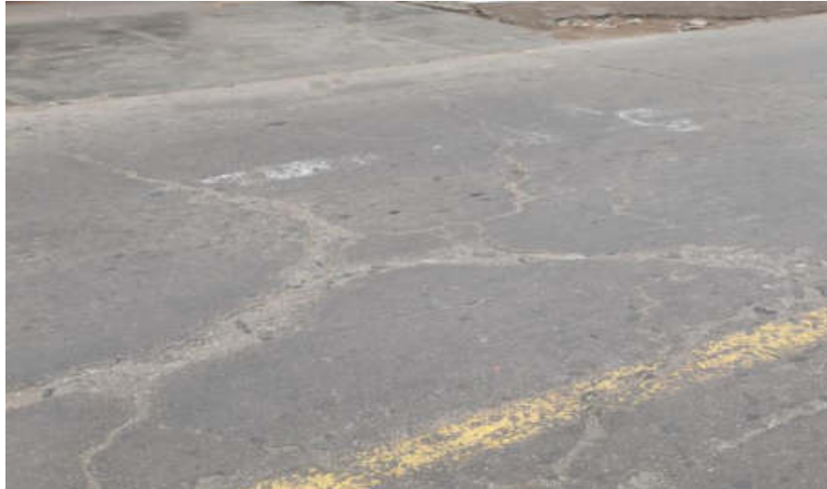
Figura 30. Falla denominada Agrietamiento en bloque
