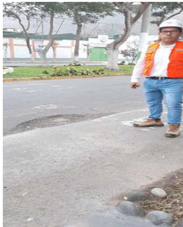
Figura 8. Identificación de piel de cocodrilo en el primer tramo Fuente: Elaboración propia
