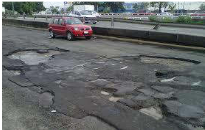
Figura 7. Fallas en el pavimento de la av. Javier Prado
