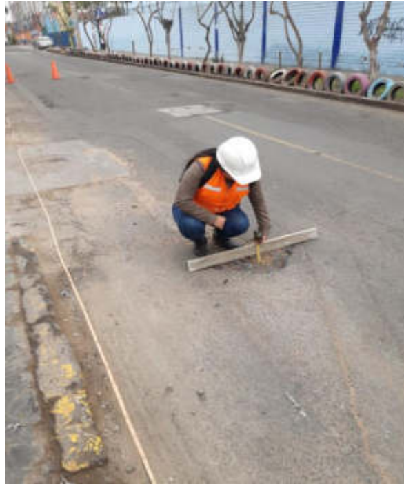
Figura 7. Identificación de hueco en el segundo tramo Fuente: Elaboración propia
