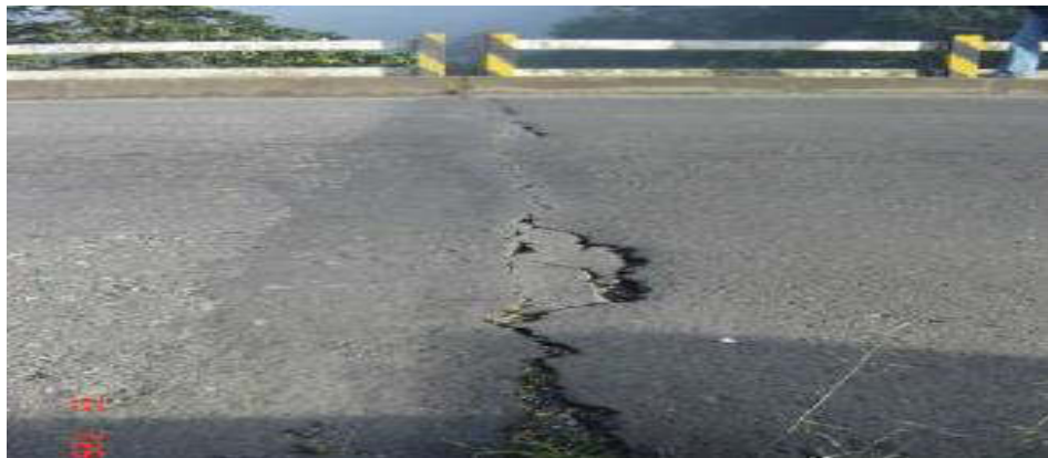
Figura 36. Falla por grieta de reflexión de junta
