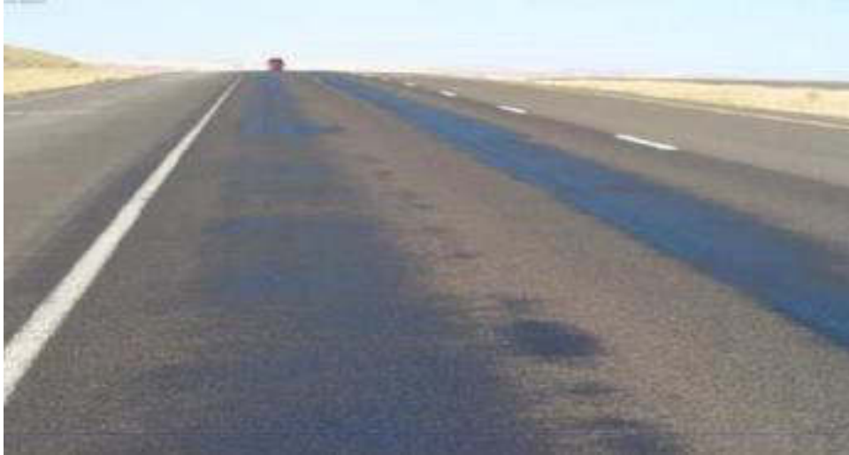
Figura 29. Falla denominada exudación
