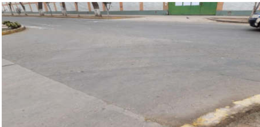
Figura 42. Falla por ahuellamiento
