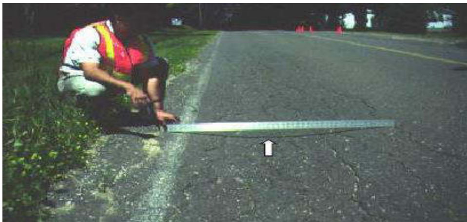
Figura 33. Falla por Depresión
