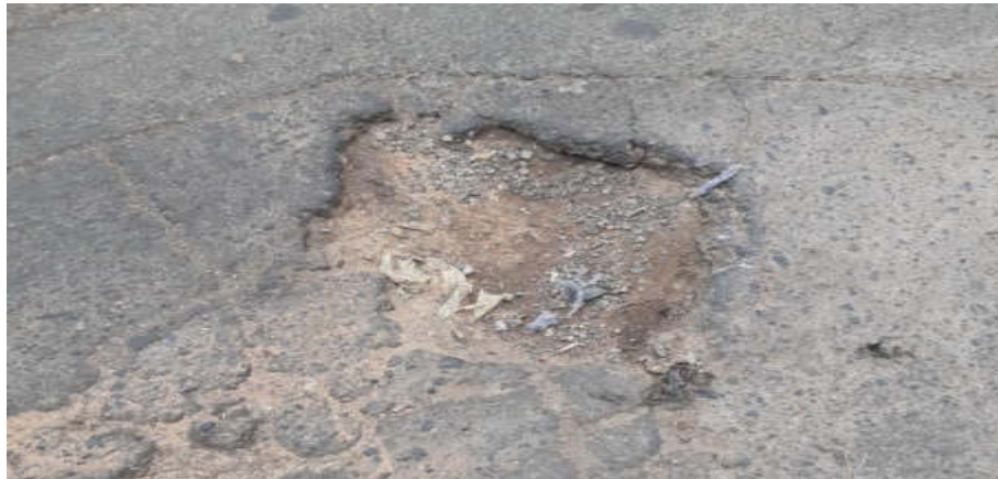
Figura 40. Falla por Huecos Fuente: Elaboración propia
