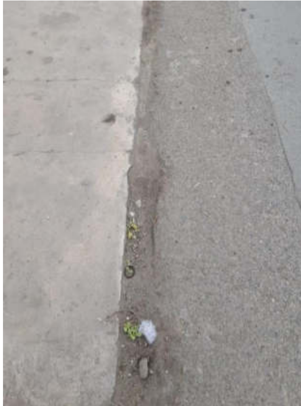
Figura 34. Falla por fisura de borde
