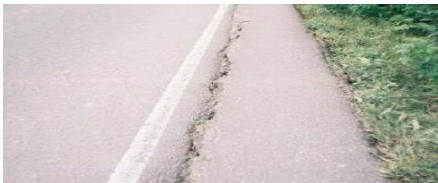
Figura 37. Falla por Desnivel carril berma
