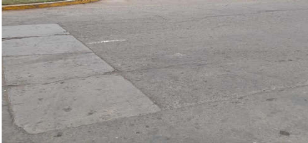
Figura 35. Falla por fisuras longitudinales y transversales
