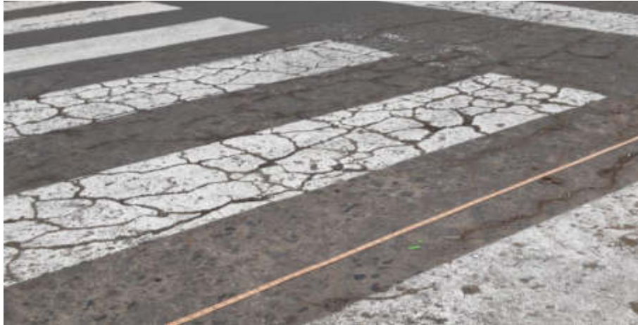
Figura 28. Falla piel de cocodrilo
