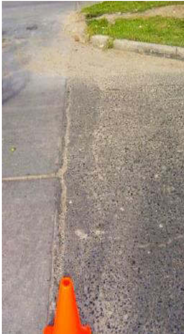
Figura 43. Falla por desplazamientos
