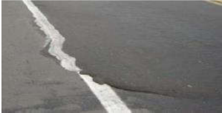
Figura 31. Falla por abultamiento
