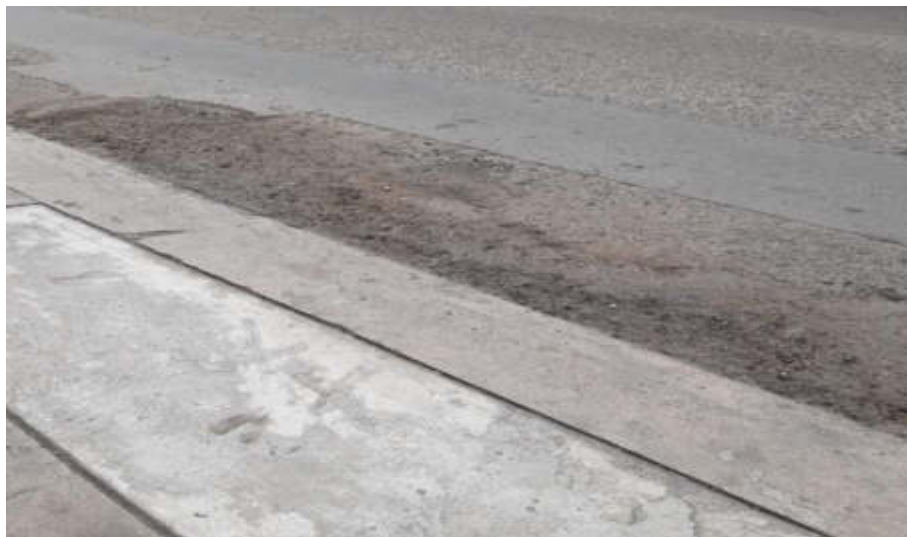
Figura 46. Falla por desprendimiento de agregados
