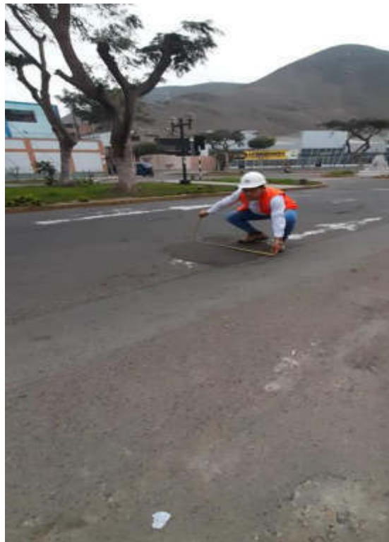
Figura 4. Identificación de abultamiento en el primer tramo Fuente: Elaboración propia
