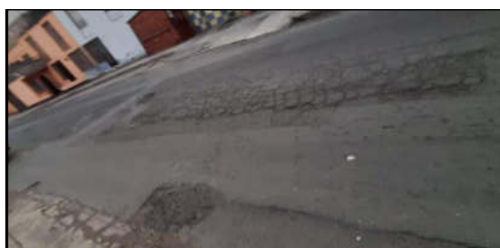
Figura 9. Falla de la Av. Venus Km 0+350
