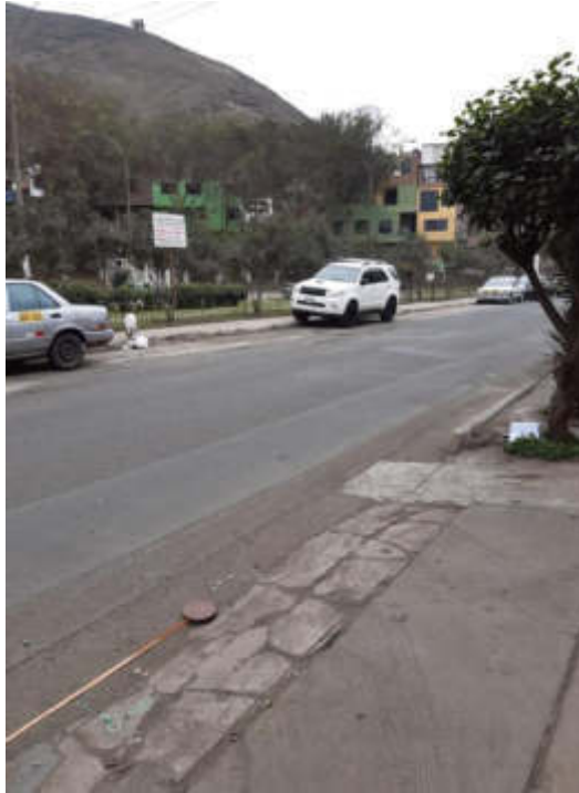
Figura 5. Identificación de parche en el segundo tramo Fuente: Elaboración propia
