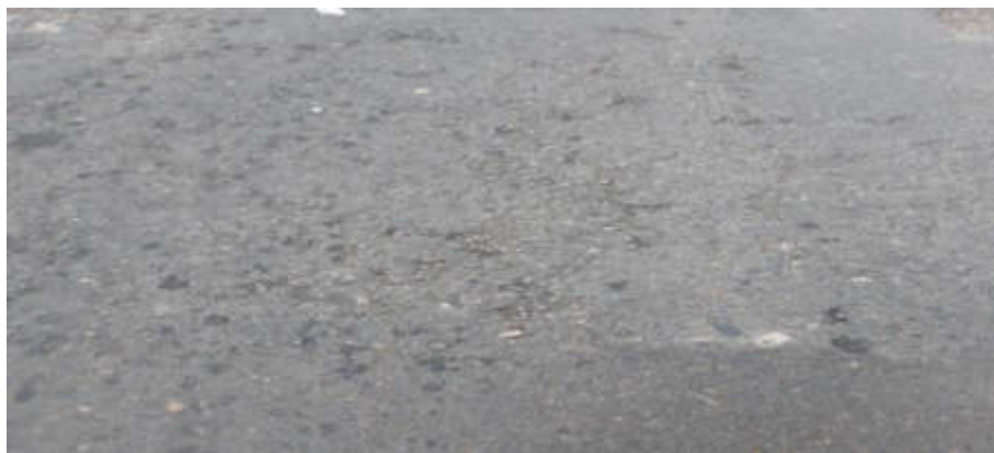
Figura 39. Falla por pulimiento de agregados
