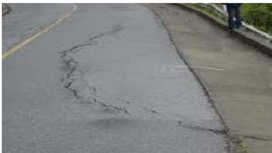
Figura 44. Falla por grieta parabólica
