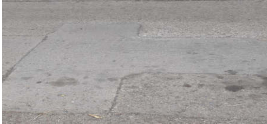
Figura 38. Falla por Parqueo
