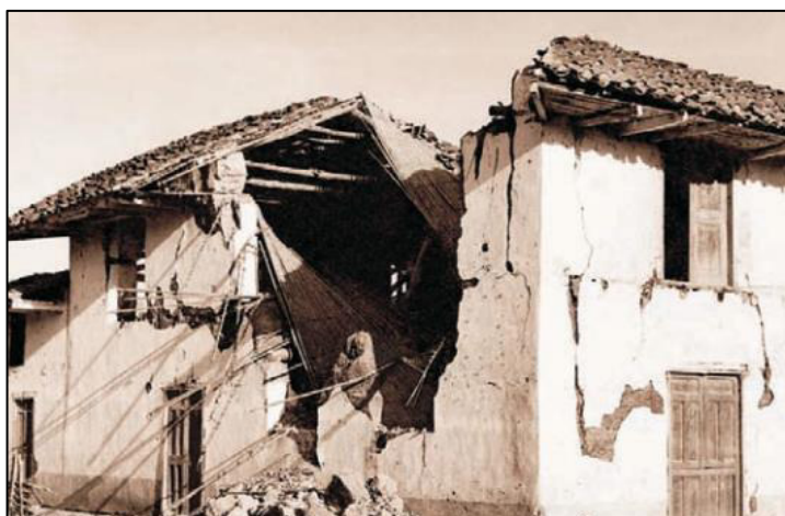
Fig. N° 1.15. Falla por flexión, volteo de parte central del muro. (Kuroiwa J. 2008)
