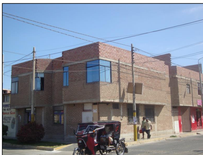
Fig. N° 3.21. Parapetos sin elemento de confinamiento. (Esquina de calles Leoncio Prado y Torres Paz)
