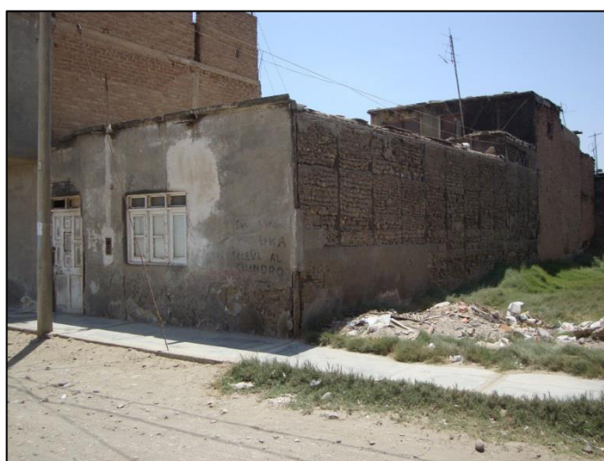
Fig. N° 3.3. Edificación de conchuela, sin elementos de arrioste en sus cuatro lados, sin adecuada distribución de muros y regularidad. (Calle Miguel Grau Cdra. 4)
