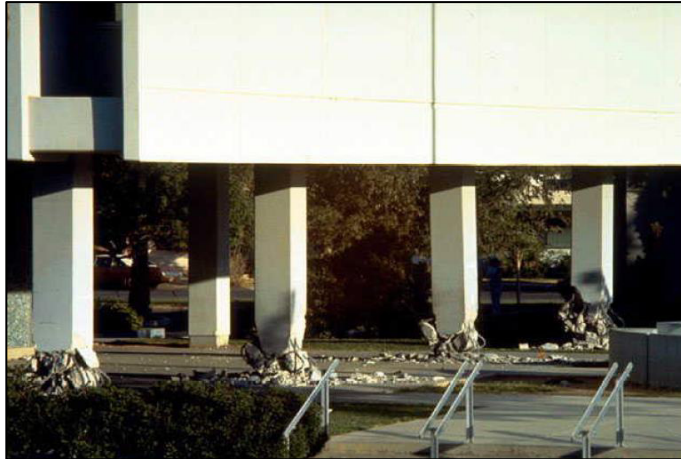
Fig. N° 1.19. Fallo súbito de las columnas del primer nivel. Sismo de Imperial Valley de 1979. (Bonnet R. 2003)
