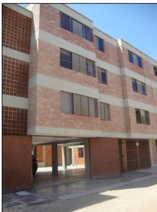
Fig. N° 3.18. Edificación de concreto armado con piso blando. (Pasaje Miraflores Cdra. 1)
