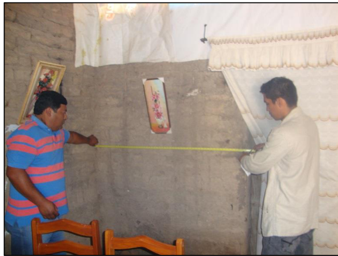
Fig. N° 3.8. Edificación con adobe de mala calidad, no existe buen amarre entre las unidades, mortero de barro de mala calidad.
