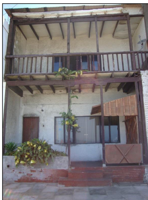
Fig. N° 3.22. Balcones inestables y en mal estado de conservación. (Calle Manuel Seoane Cdra. 3)
