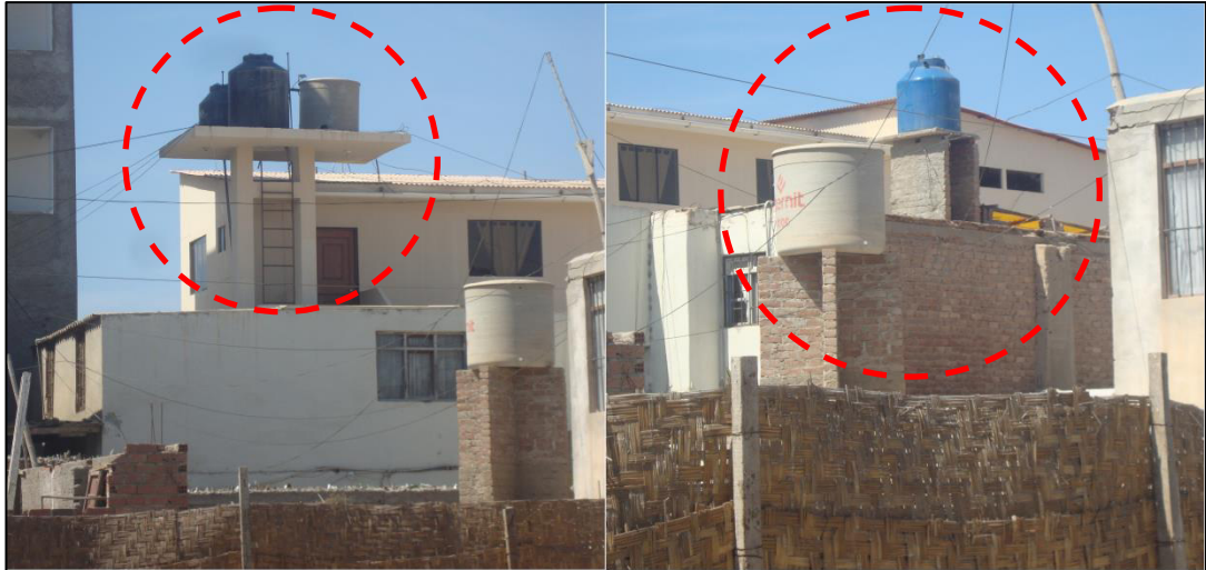
Fig. N° 3.23. Izq: Tanque de agua adecuadamente apoyado. Der: Tanques de agua mal apoyados. (Calle Manuel Seoane Cdra. 7)
