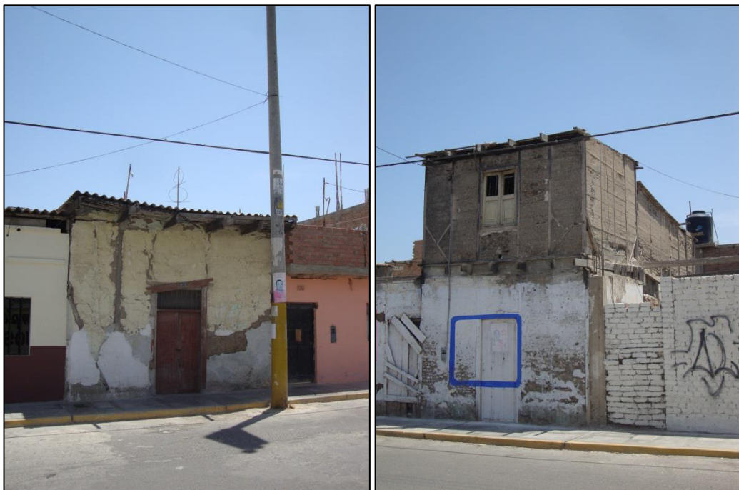
Fig. N° 3.24, Fig. N° 3.25. Edificaciones de adobe y conchuela con grietas y fuerte deterioro en sus componentes.(Calle Chiclayo Cdra. 4)
