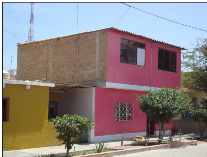
Fig. N° 3.5. Edificación con deficiencias en confinamiento, ausencia de viga en el segundo nivel. (Calle Nicolás de Piérola Cdra. 1)
