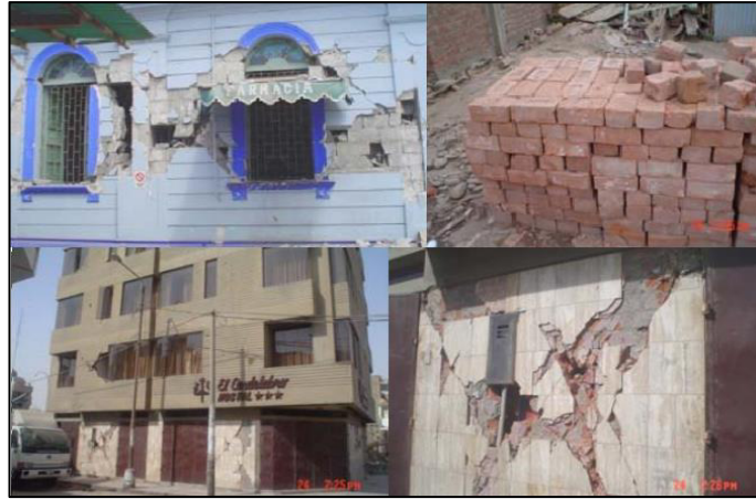
Fig. N° 1.20. Uso de unidades inadecuadas en edificios. Pisco, Perú. (San Bartolomé A. 2007)
