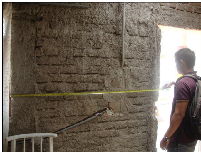
Fig. N° 3.9. Edificación con ladrillo artesanal, no existe buen amarre entre las unidades, mortero de mala calidad.
