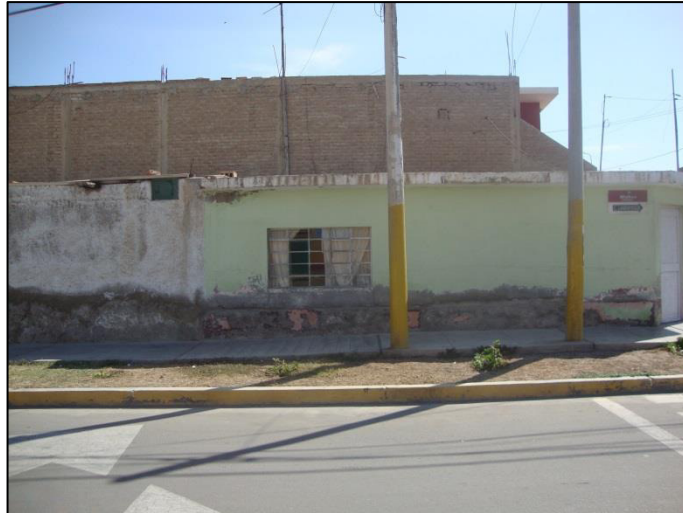
Fig. N° 3.11. Edificaciones de albañilería afectadas por la presencia de humedad y sales. (Esquina de calles Lambayeque y Torres Paz)
