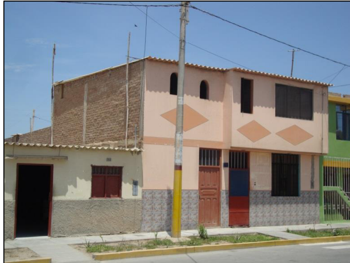
Fig. N° 3.19. Muro longitudinal con aparejo de soga ( e=0.13 m.), distancia aprox. de 3.50 m. entre elementos de confinamientos. (Calle Manco Cápac Cdra. 3)
