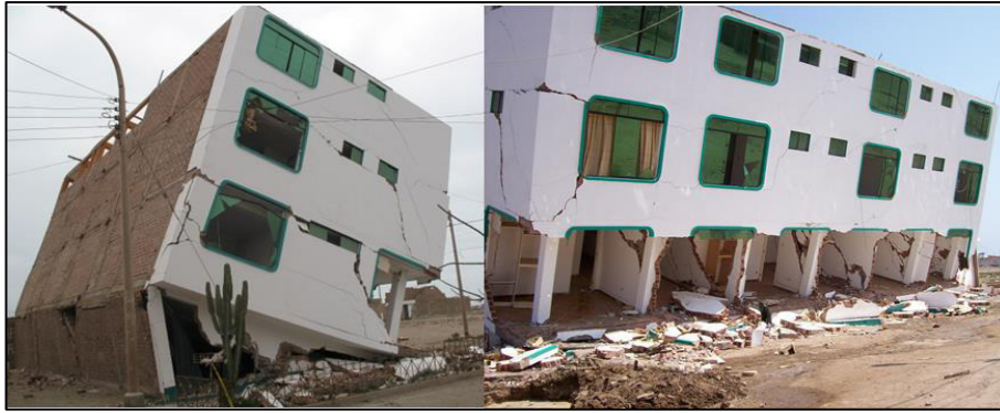
Fig. N° 1.24. Falla por piso blando. Pisco, Perú. (San Bartolomé A. 2007)
