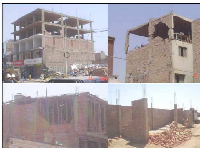
Fig. N° 1.22. Volcamiento de muros con junta a ras con las columnas. Inadecuadamente, la albañilería fue construida después que las columnas. Pisco, Perú. (San Bartolomé A. 2007)
