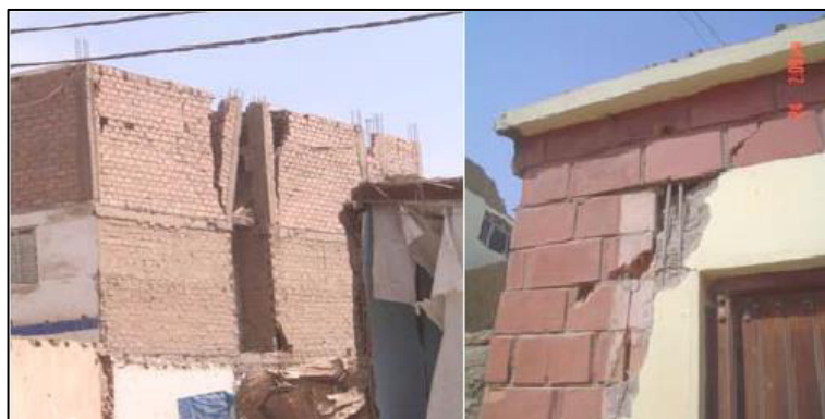
Fig. N° 1.28. Izq.: Muros sin viga solera. Der.: Unión viga columna sin estribos. La NTE E.070 obliga colocar por lo menos 2 estribos. Pisco, Perú. (San Bartolomé A. 2007)
