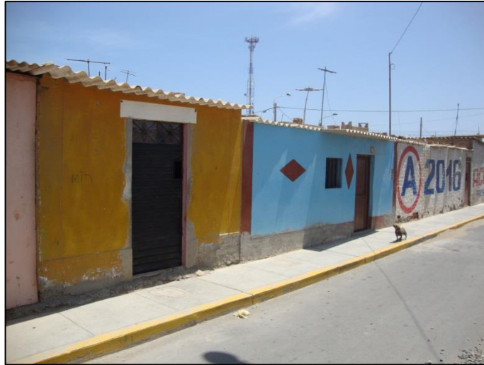
Fig. N° 3.13. Edificaciones de albañilería con ausencia de diafragma rígido. Techo únicamente con cobertura liviana. (Pasaje Los Parques Cdra. 1)
