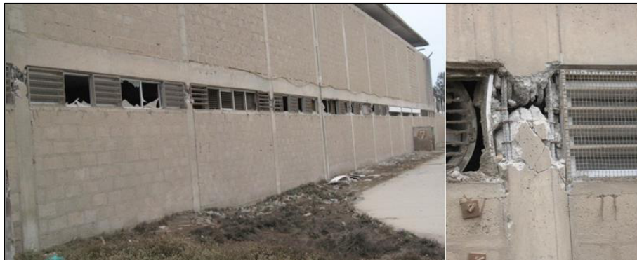
Fig. N° 1.23. Falla por columna corta. Pisco, Perú. (San Bartolomé A. 2007)
