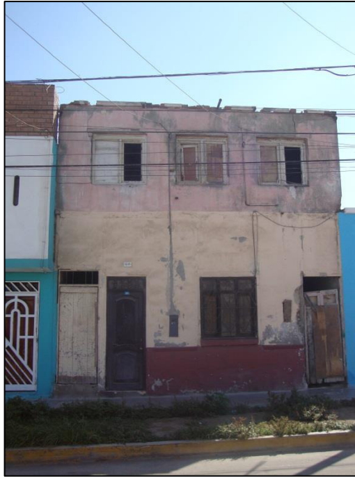
Fig. N° 3.26. Edificación de albañilería con fisuras y componentes estructurales deteriorados.(Calle Lambayeque Cdra. 4)
