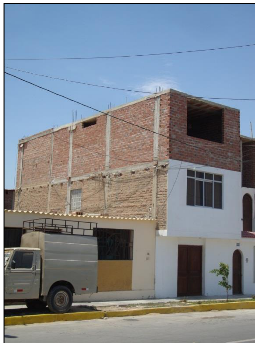
Fig. N° 3.16. Edificación de albañilería con cambio en la calidad de los materiales. (Calle Ciro Alegría Cdra. 1)
