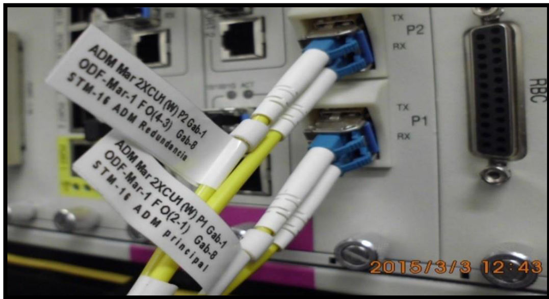
Figura 26: Conexiones ópticas en el nodo Maranga 2
