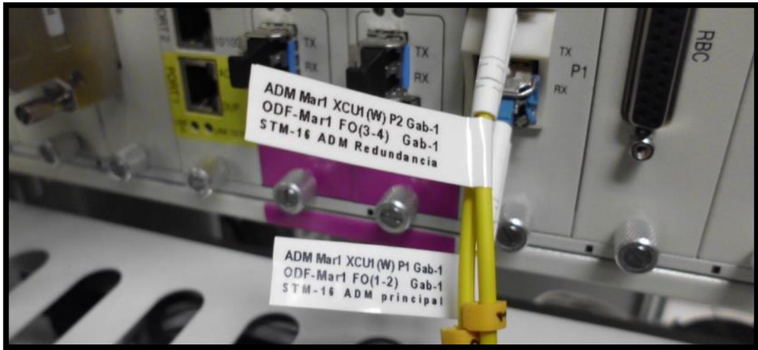
Figura 24: Conexiones ópticas en el nodo Maranga 1
