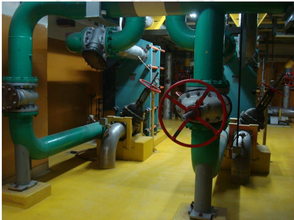
Figura: Intercambiadores de calor
