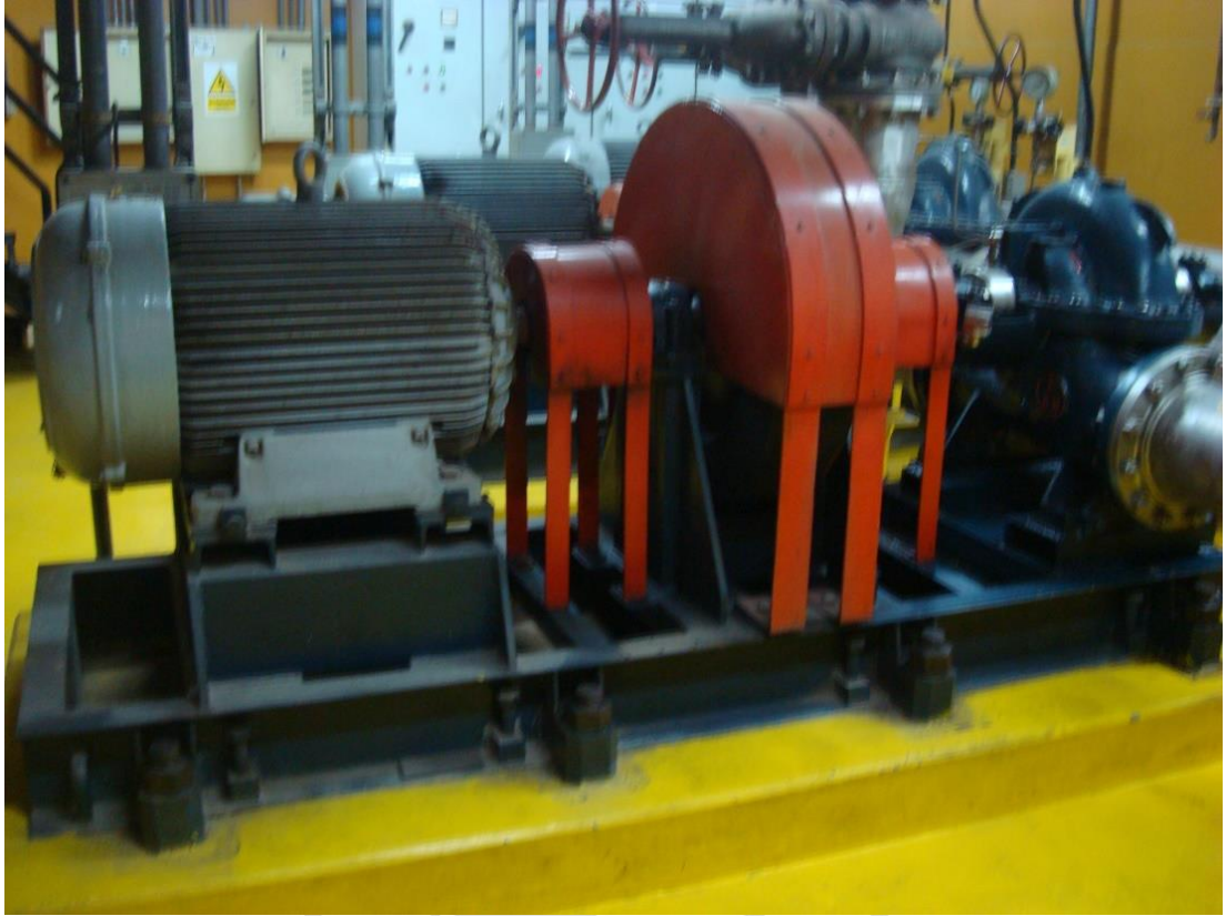
Figura: Bomba - Motor del Sistema primario de refrigeración, se observa además, la volante de inercia y el lugar de acople motor-bomba.
