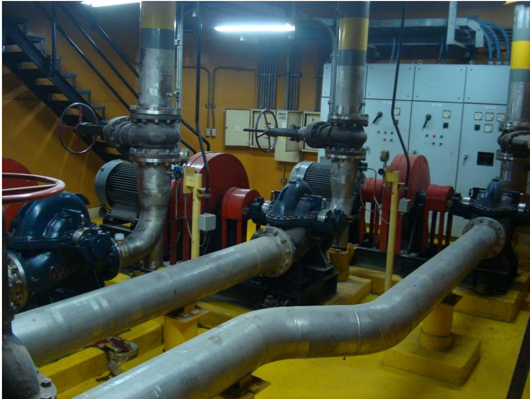
Figura: Layout de Bombas de refrigeración del Sistema Primario.
