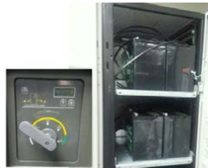
Figura 5. UPS del centro de cómputo de la Facultad de Ingeniería y Arquitectura.
