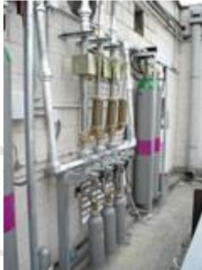
Figura N° 24.- Equipos Anti-Incendio – Sistema Gas Inerte Argón Fuente: Fenipresa S.A
