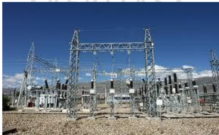
Figura N° 46.- Ejemplo de Patio de Llaves – Subestación Fuente: COES
