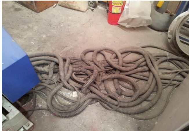
Figura N° 149: Cables regados por el suelo. Fuente: Industrias Plásticas MarPlast S.A.C.
