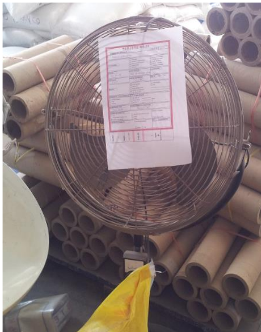
Figura N° 11: Tarjeta roja en ventilador del área de almacén de M.P. Fuente: Industrias Plásticas Marplast S.A.C.
