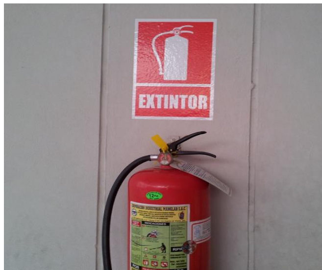
Figura N° 95: Pegatina de extintor en almacén M.P. Fuente: Industrias Plásticas Marplast S.A.C.
