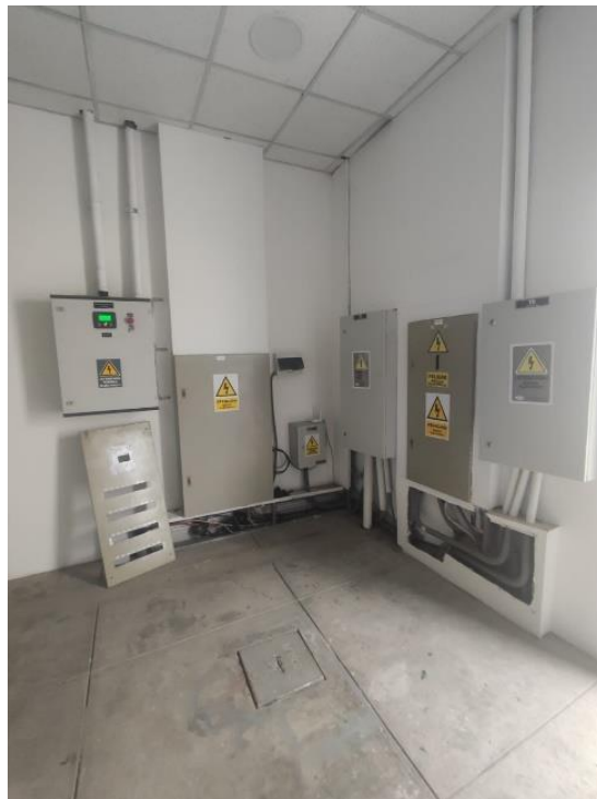
Figura 3: Cuarto de tableros antiguos y nuevos Fuente: Elaboración propia
