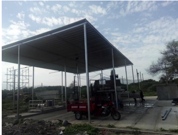
Figura 37: Planta de tratamiento de aguas residuales
