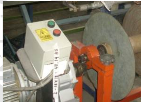
Figura N°2.21 Señales de peligro eléctrico
