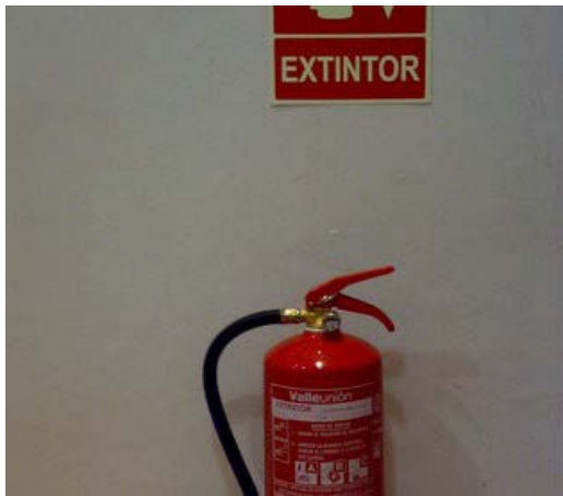
Figura N°2.18 Señalización de extintores LEÓN PLAST
