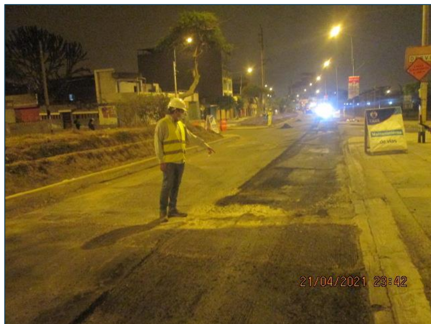
Figura 34. Inspección e identificación de fallas
