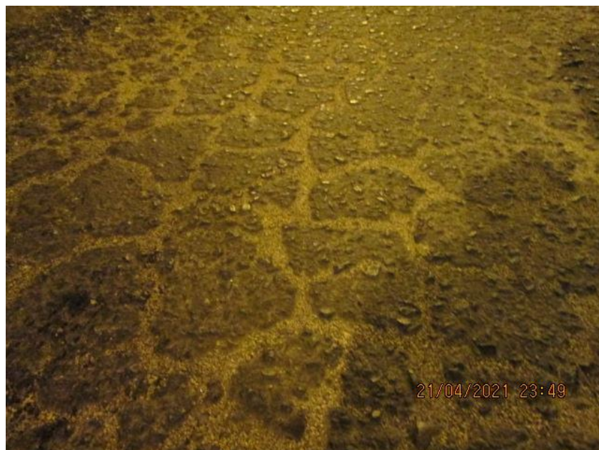
Figura 15. Fallas en pavimentos
