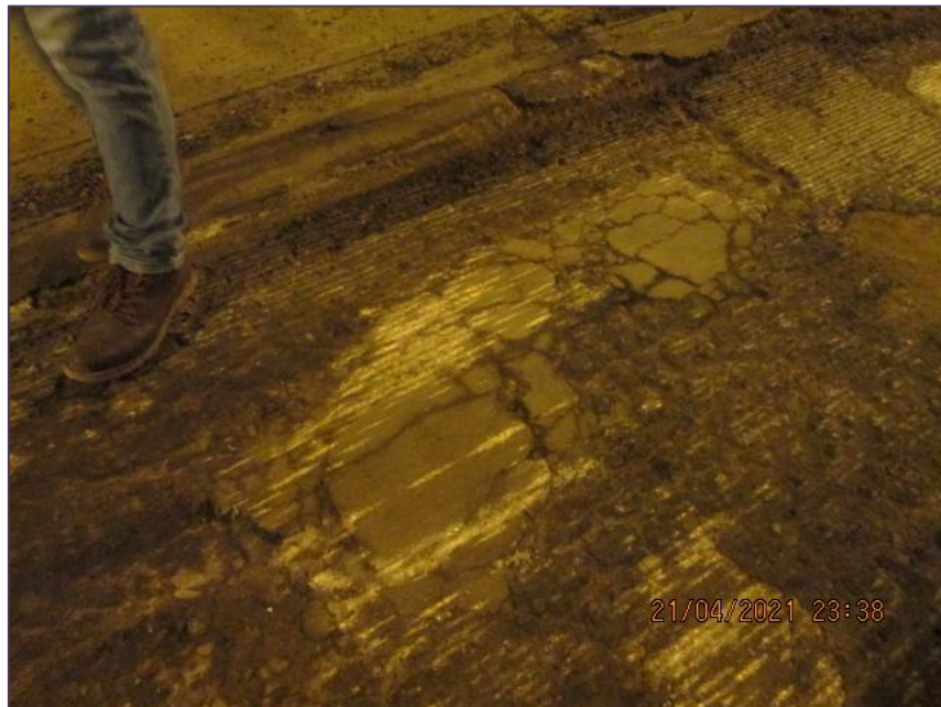
Figura 4. Fallas en los pavimentos
