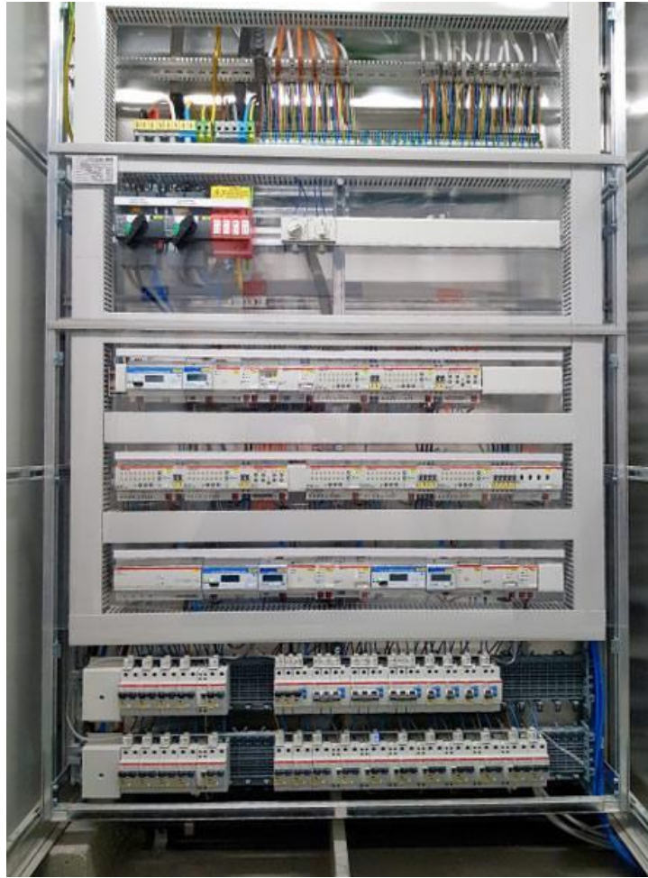
Figura 24: Cabina KNX - Componentes de la marca ABB Fuente: (Bonutto A., 2019)
