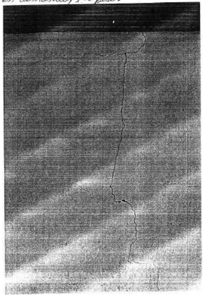
Rafadura pared de la cocina por abajo de la ventana que da con el jardín trasero, 1er piso.
