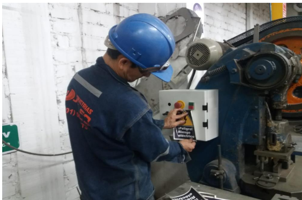
Figura 211. Señalización de ¡Peligro, riesgo eléctrico! Adaptado por los autores de la información proporcionada por la empresa Industrias Jelco E.I.R.L
