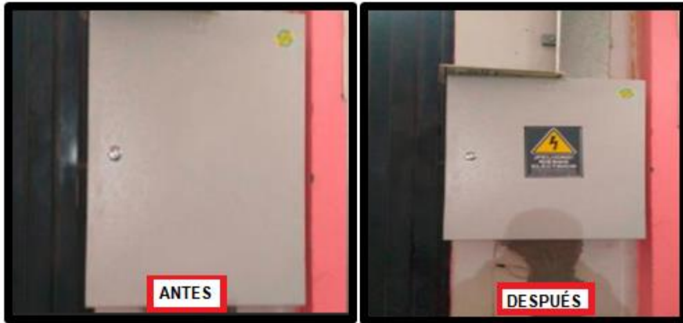
Figura YY 25. Señalización de riesgo eléctrico Elaborado por: los autores
