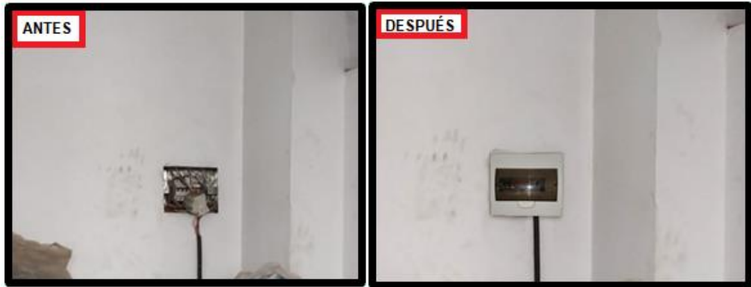
Figura YY 27. Cables expuestos Elaborado por: los autores
