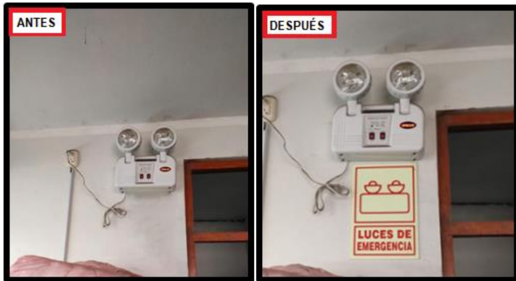
Figura YY 21. Señalización de luces de emergencia Elaborado por: los autores
