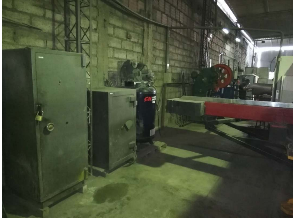
Figura 372. Ubicación de equipos Fuente: Elaboración de los autores.
