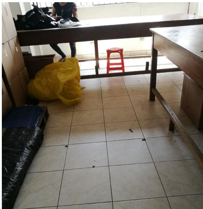
Figura 344. Área de acabados limpio Elaborado por: los autores
