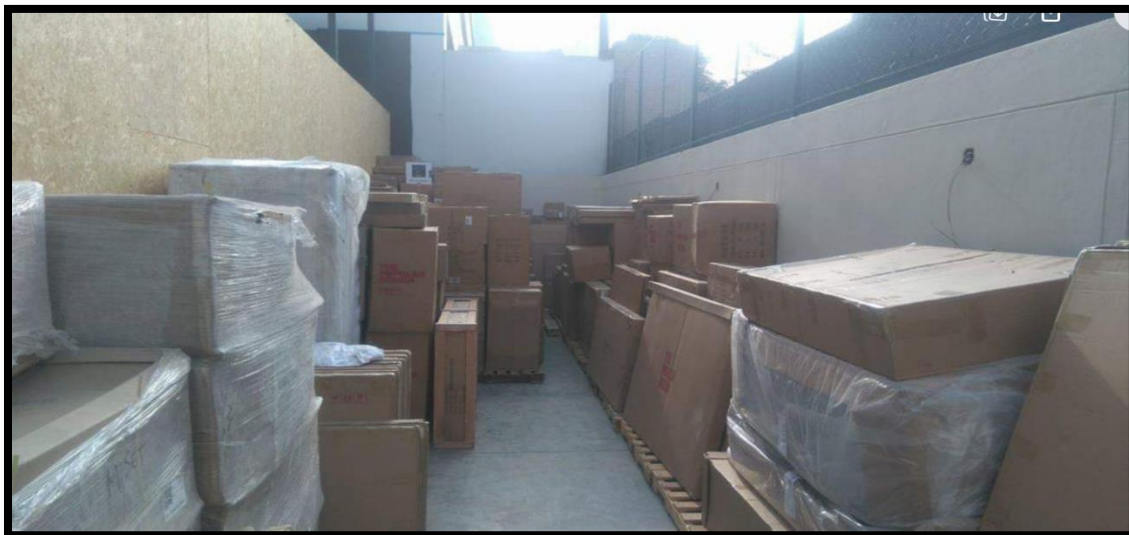
Fotografía 2. Falta de techo, no hay iluminación
