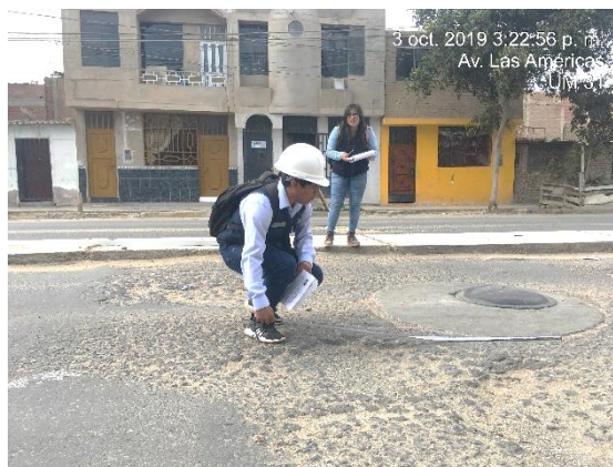
Figura N° 40. Desprendimiento de agregados de severidad alta
