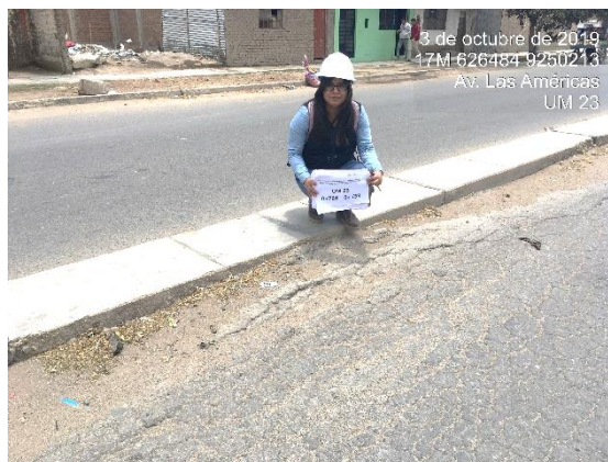
Figura N° 39. Piel de cocodrilo de severidad alta
