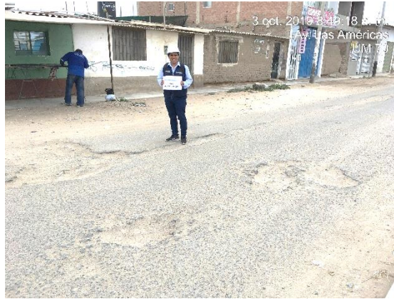
Figura N° 38. Huecos de severidad alta
