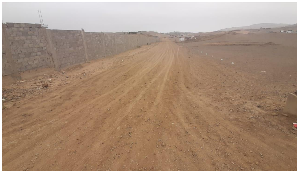
Figura N° 5: plataforma con pérdida de agregados
