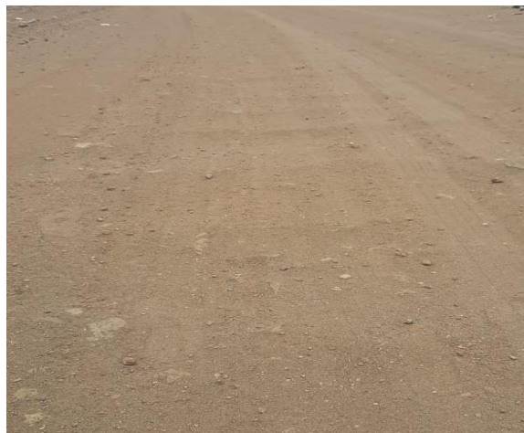
Figura N° 4: Plataforma con falla de encalaminado
