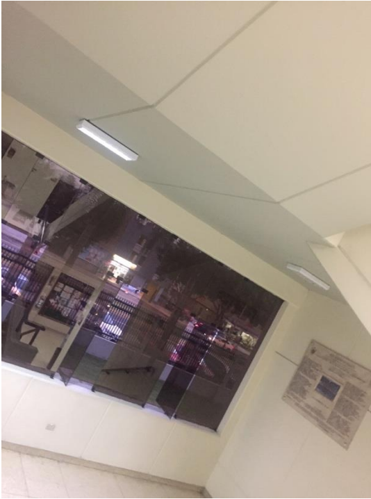
Figura 21. Iluminación Deficiente En Escaleras Hacia El Sótano.
