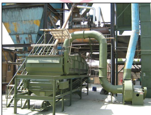
Figura 61 - Disposición actual de la tubería de succión de aire en el enfriador Elaborado por los autores
