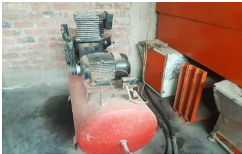
Figura 67. Compresor de aire sucio
