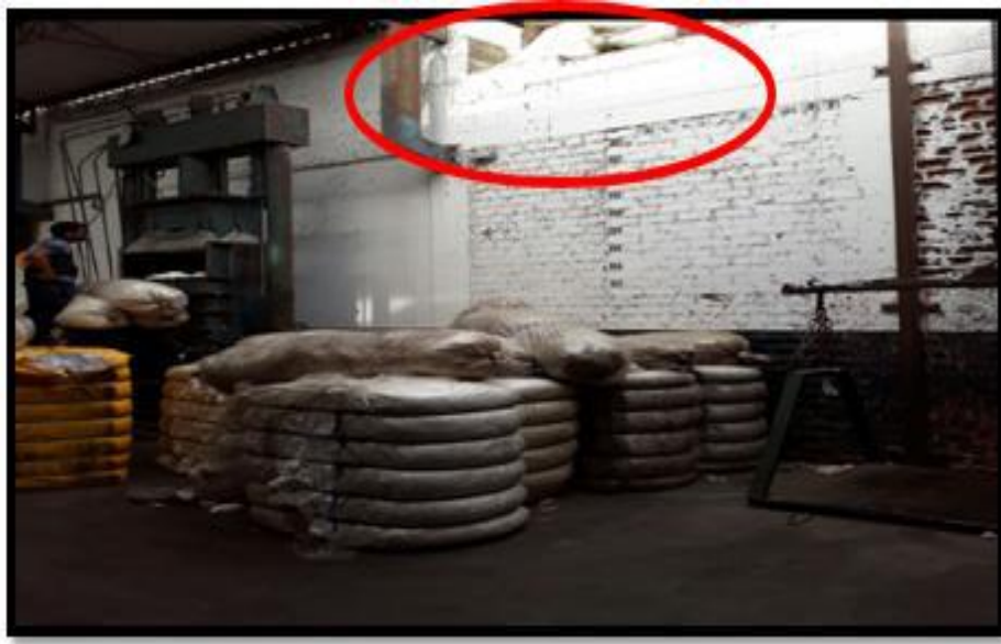
Figura 173. Zona de alto riesgo
