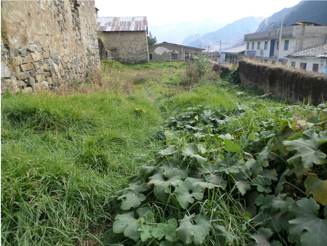
Imagen 103. El tamaño de la grama y las plantas de calabaza permiten afirmar cómo esta vegetación afecta la base de los muros y contribuye a su deterioro. Fuente. Archivo personal. Foto tomada el 26 de julio de 2017.
