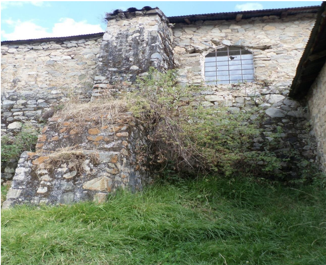
Imagen 115. Se aprecia en la base de la pared abundante pasto y plantas creciendo sobre los muros. Fuente. Archivo personal. Foto tomada el 26 de julio de 2017
