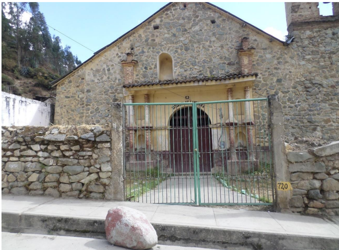
Imagen 106. Puerta de rejas colocada entre los muros de amortiguamiento. Al fondo en una parte de la pared se observa la pared estucada y pintada de color amarillo. Fue una intervención sin ningún plan de conservación y rompe la armonía con la construcción original. Fuente. Archivo personal. Foto tomada el 26 de julio de 2017
