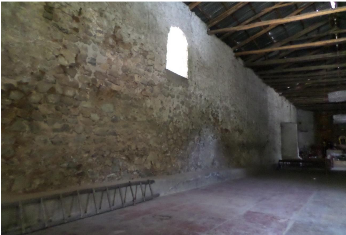
Imagen 120. Se puede apreciar la otra pared donde se observa que el cemento salpicado y la pintura fueron desapareciendo. Fuente. Archivo personal. Foto tomada el 26 de julio de 2017.
