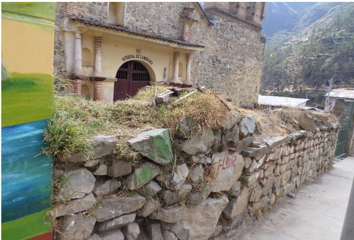
Imagen 104. Imagen del muro de amortiguamiento ubicado en el frontis de la iglesia. Se observa que una parte del muro no corresponde a la construcción original. Fuente. Archivo personal. Foto tomada el 26 de julio de 2017.
