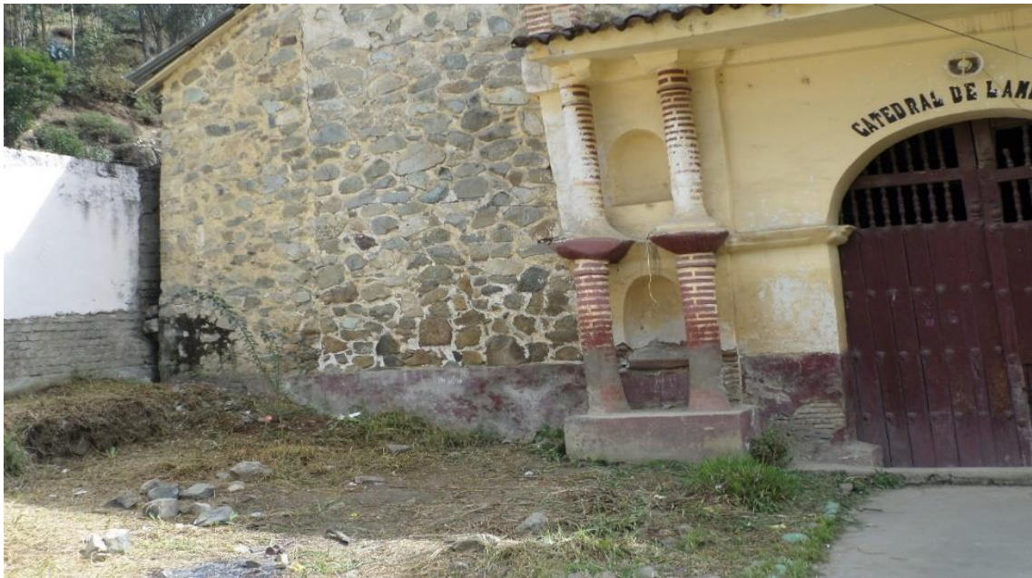
Imagen 105. Patio entre el muro de amortiguamiento y la pared de la iglesia en completo estado de abandono. Fuente. Archivo personal. Foto tomada el 26 de julio de 2017.
