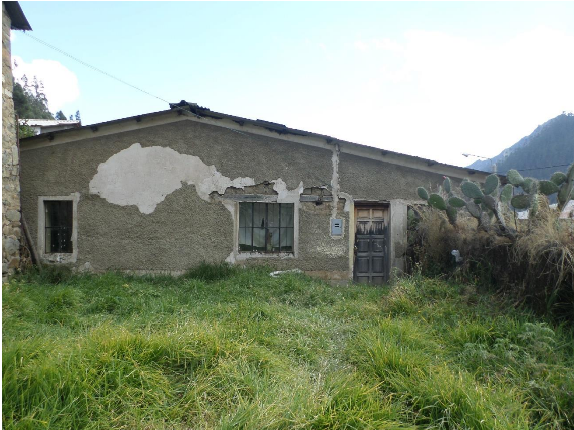
Imagen 112. Podemos apreciar la casa del párroco que actualmente está abandonada. Fuente. Archivo personal. Foto tomada el 26 de julio del 2017.
