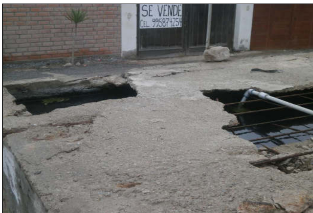
Figura 2. Tanque de agua en mal estado
