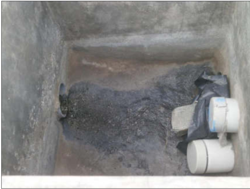
Tuberías expuestas a la contaminación
