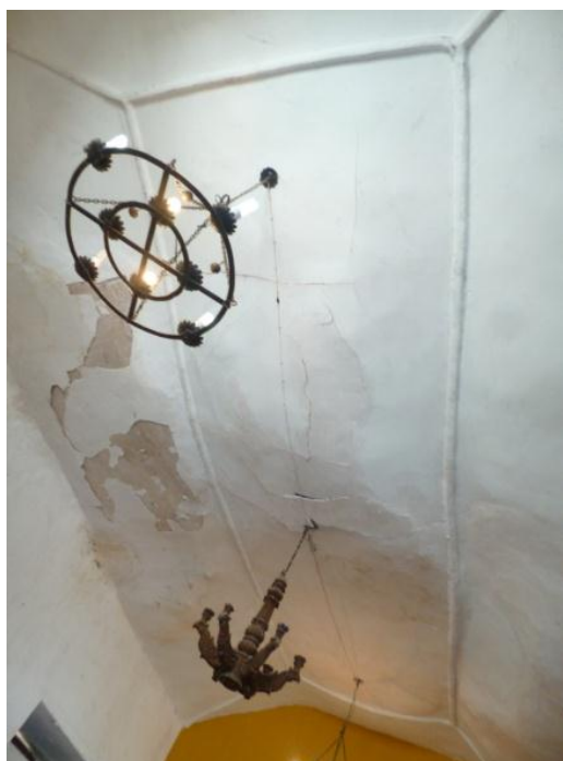
Fig 19 Interior de la casa museo Andrés Avelino Cáceres. Se observa un problema de pandeo en la estructura del techo, del segundo nivel. Fuente Propia
