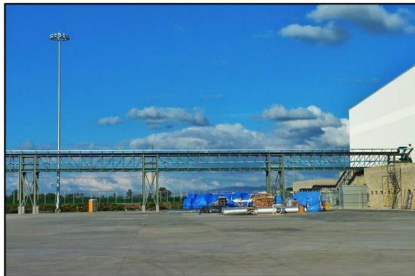
FIGURA 2 : Pase aéreo de acero construido para tubería de gas en México
