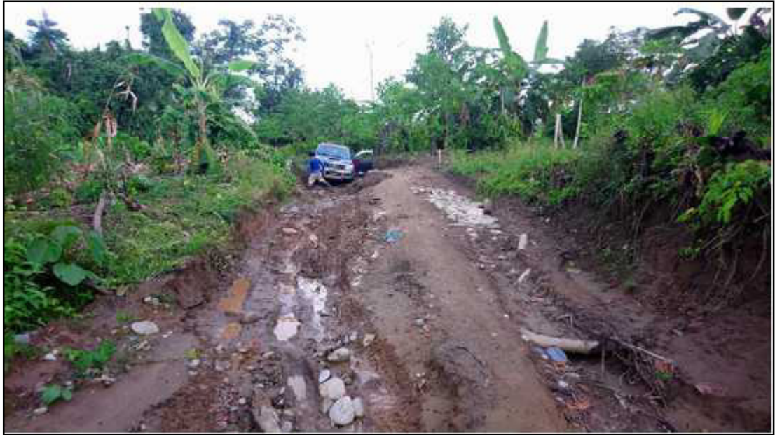
Plataforma erosionada a falta de cunetas longitudinales
