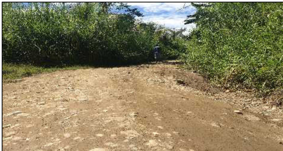
Figura N° 3: Plataforma erosionada a falta de cunetas
