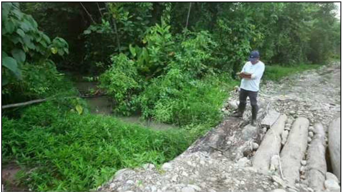
Falta de alcantarilla de cruce
