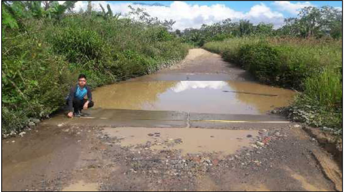
Badenes existentes en mal estado
