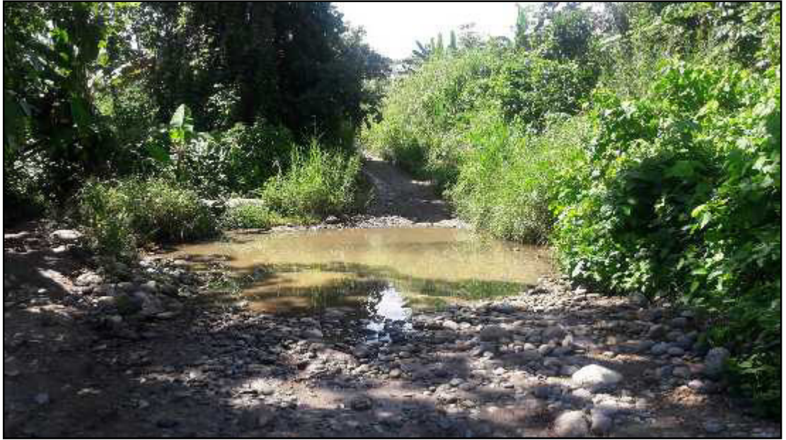
Falta de obras de drenaje
