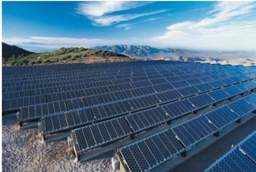
Figura 1: Campo solar de placas fotovoltaicas
