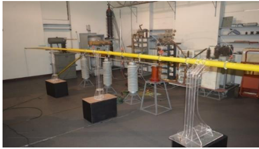
Figura N° 31: Laboratorio de alto voltaje.
