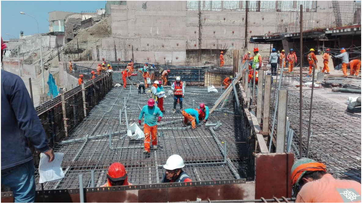
Anexo 31. Fotografía del Condominio Ocean Reef - Verificación de Instalaciones sanitarias en Piscina Sótano 4. Primera Etapa
