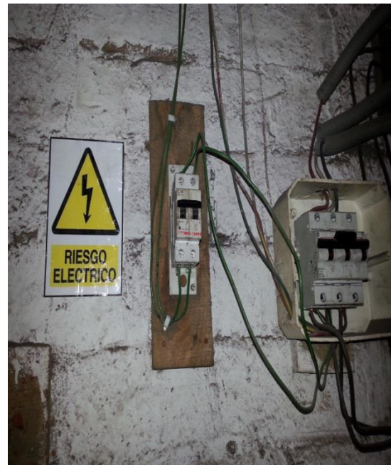
Señal de riesgo eléctrico
