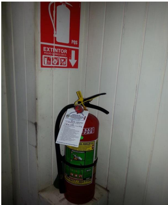
Extintor 01 en el área administrativa
