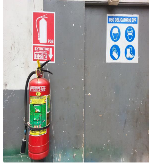
Extintor 01 en el área de almacén
