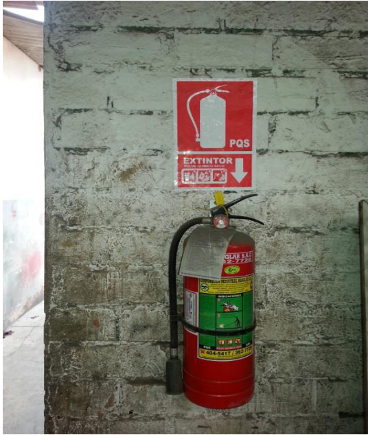
Extintor 03 en el área de planta
