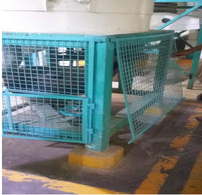
Figura 24: Refuerzo de máquinas con guardas
