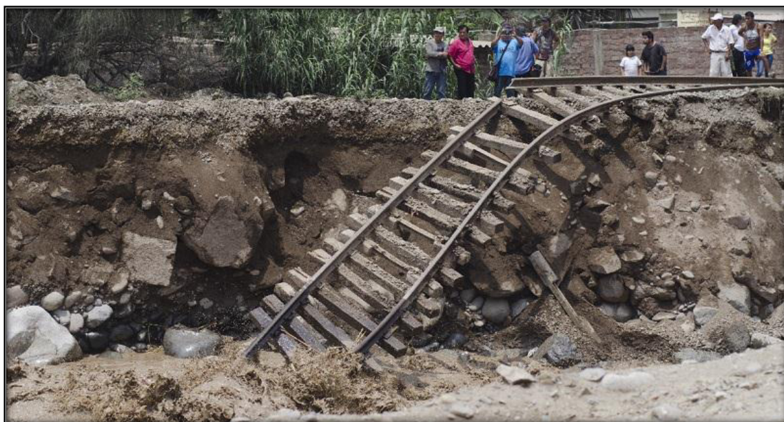
Figura 47: Riel ENAFER Perú Colapsado — Elaboración: el autor
