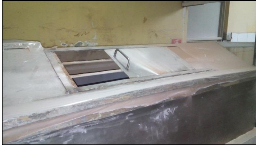
Figura 75: Compuerta de ingreso de insumos en mezcladora 2
