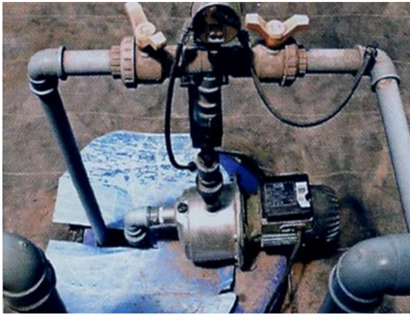
Figura 6: Bombas y tubería – Sistema NFT Fuente: Adaptado de Hidroponía, Martha Álvarez. 2011
