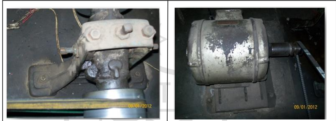
Ilustración 21.- Anclaje de motor para máquinas de tejido
