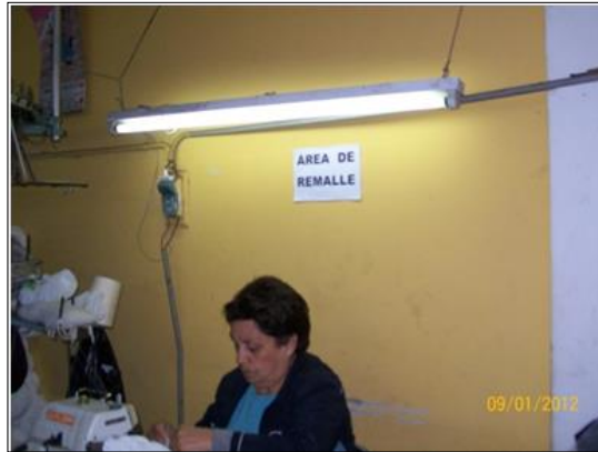
Ilustración 27 .- Luminarias en el área de remalle
