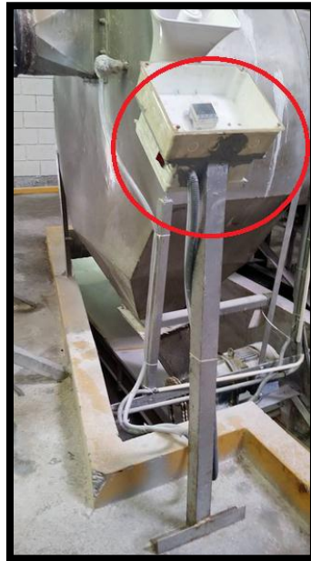
Figura 97 Sensor de Temperatura para controlar temperatura
