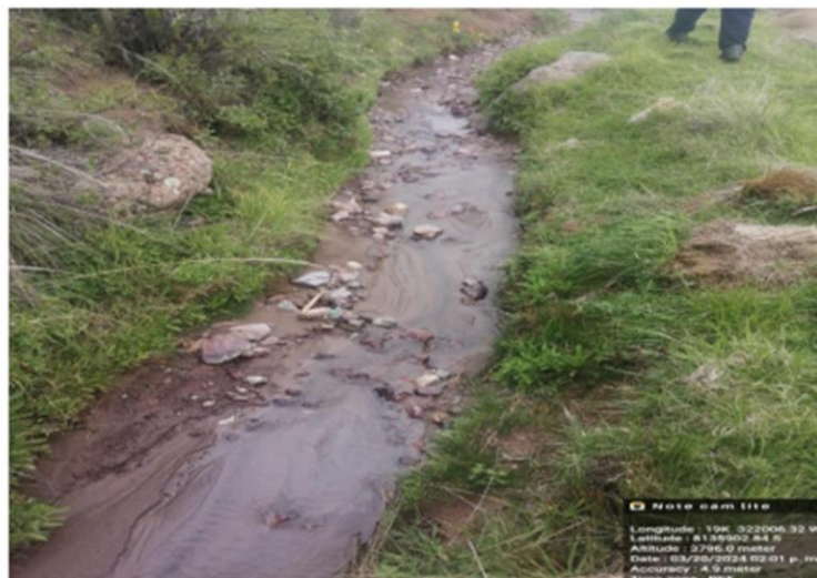
Fotografía 38 Canal colmatado deslizamiento y sedimentos
