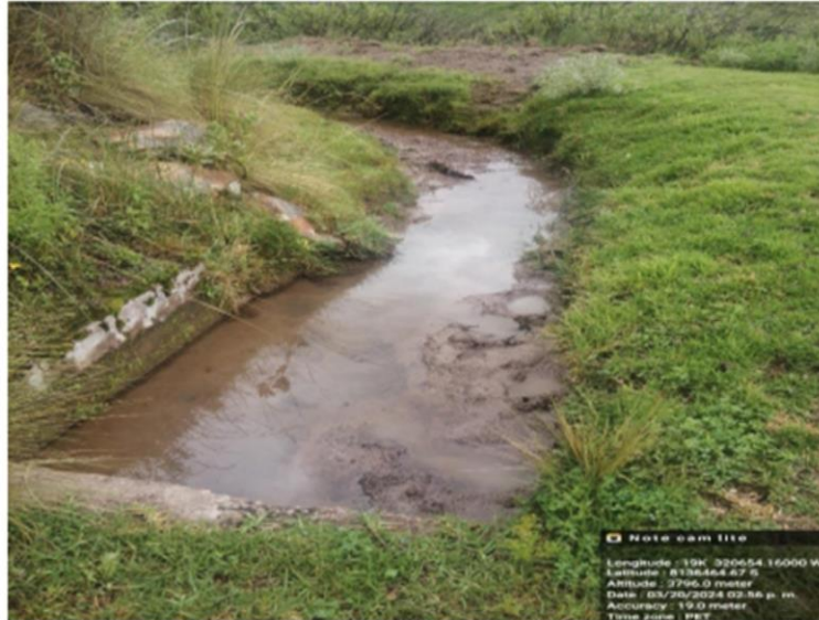
Fotografía 45 Canal colmatado por sedimentos – tramo tubería
