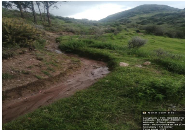
Fotografía 37 Canal colmatado deslizamiento y sedimentos
