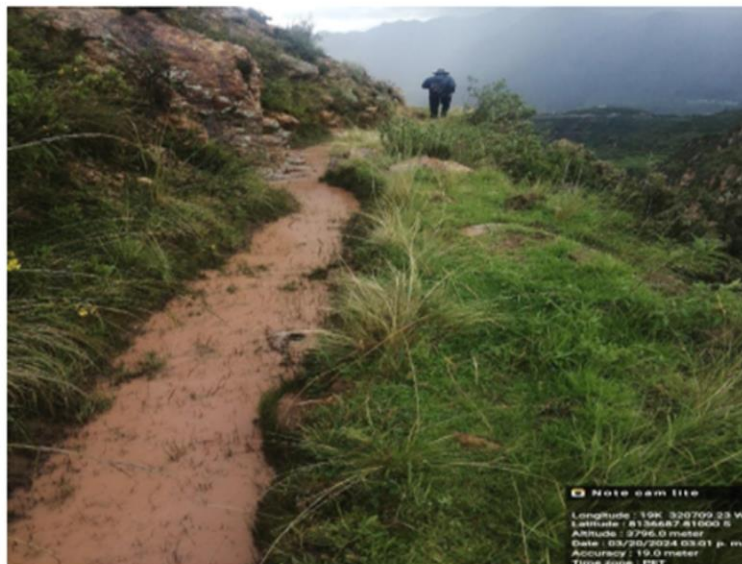
Fotografía 46 Canal colmatado por sedimentos y deslizamiento
