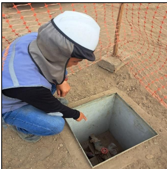
Válvula de control en el C.P. Barbacay
