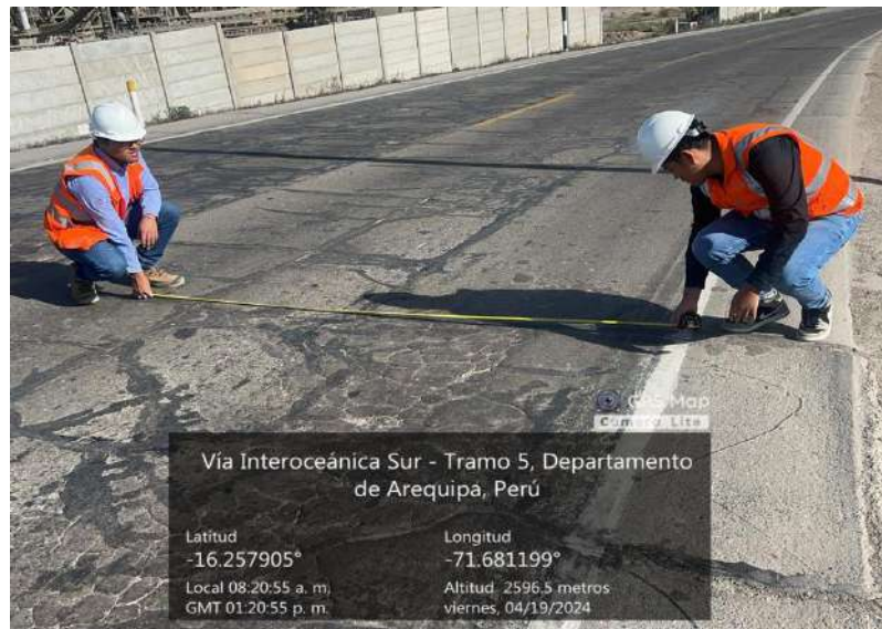
Figura 46. Medición para la falla tipo agrietamiento en bloque
