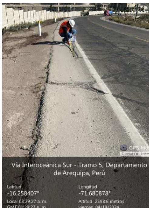
Figura 49. Medición de la falla tipo grieta de borde
