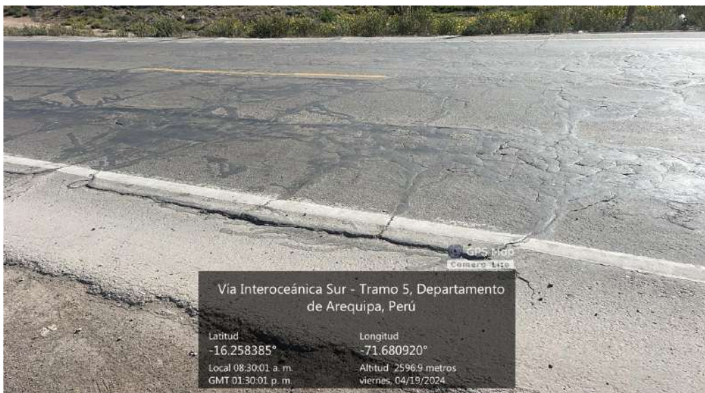
Figura 48. Falla tipo grieta de borde
