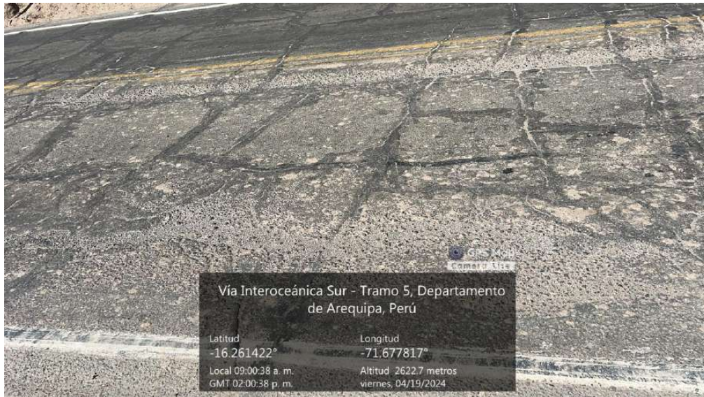
Figura 36. Tipo de Falla: Agrietamiento en bloque tramo de estudio
