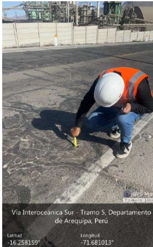
Figura 47. Medición para el nivel de severidad de la falla
