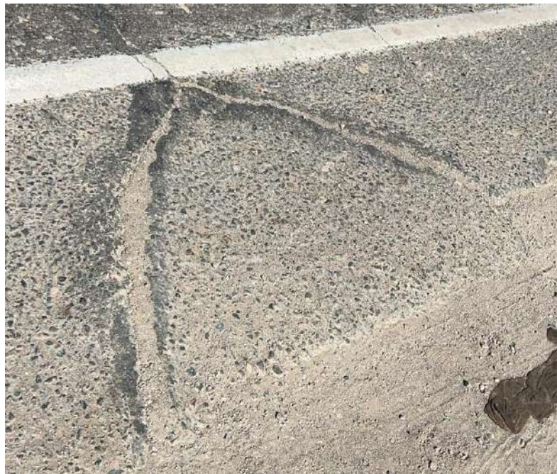
Figura 37. Tipo de Falla: Grieta de borde Tramo de la carretera Arequipa-entrada a Yura
