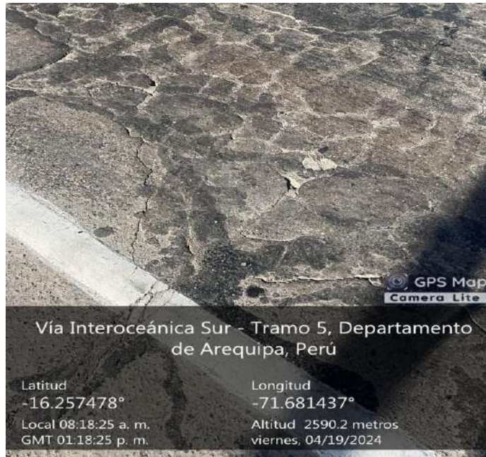
Figura 45. Falla tipo agrietamiento en bloque
