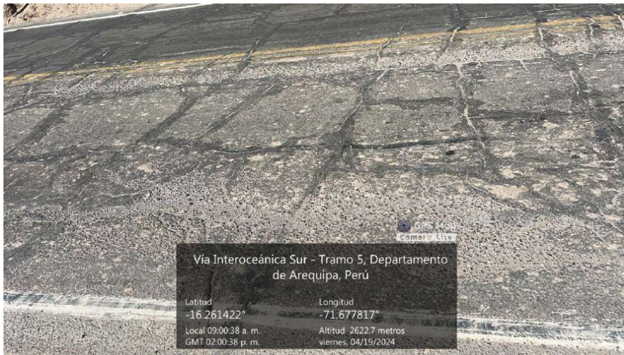
Figura 7. Agrietamiento en bloque
