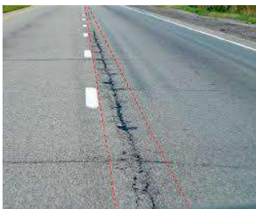
Figura 8. Fisura longitudinal y transversal junta de construcción.
