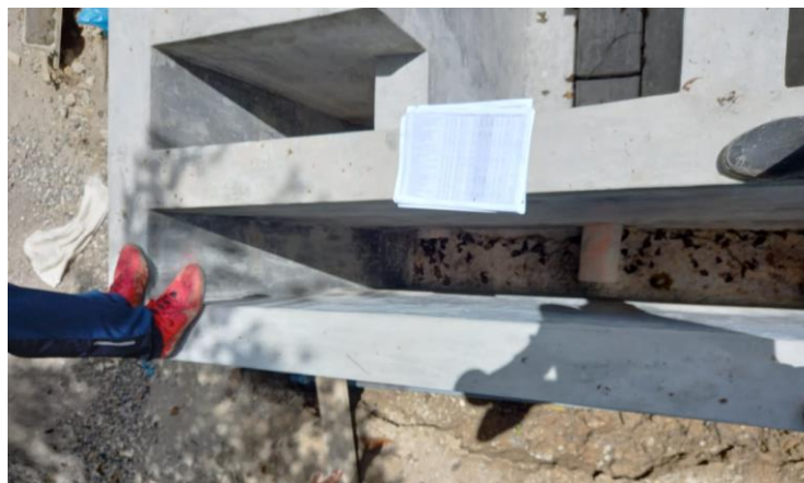
Figura 15 Vista del pre filtro de la camara que se desea ampliar
