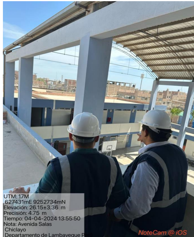
Figura 18. Identificación de puntos de fallo estructural
