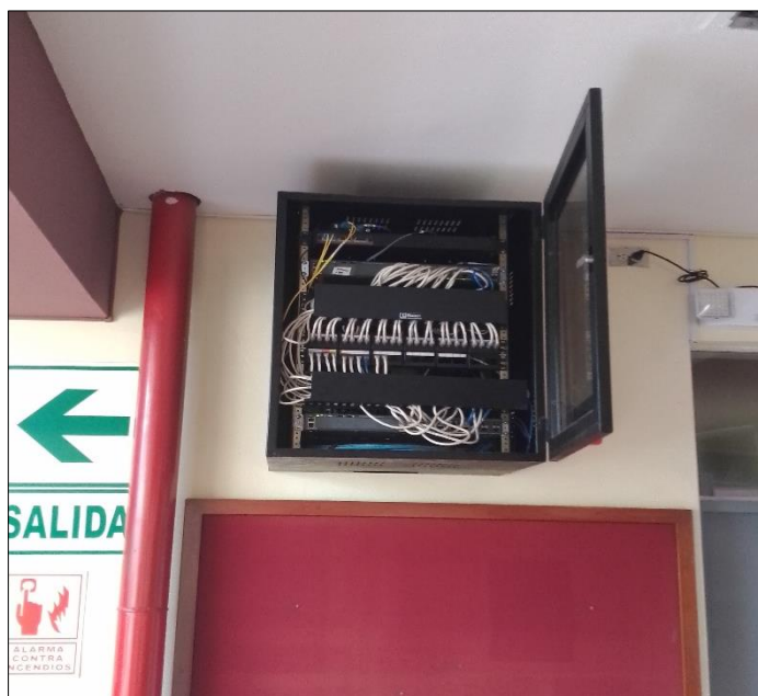
Figura 30 Gabinete de Comunicaciones Aulas
