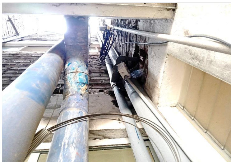
Figura 31 Paso Tubería Vista desde el Cuarto Nivel
