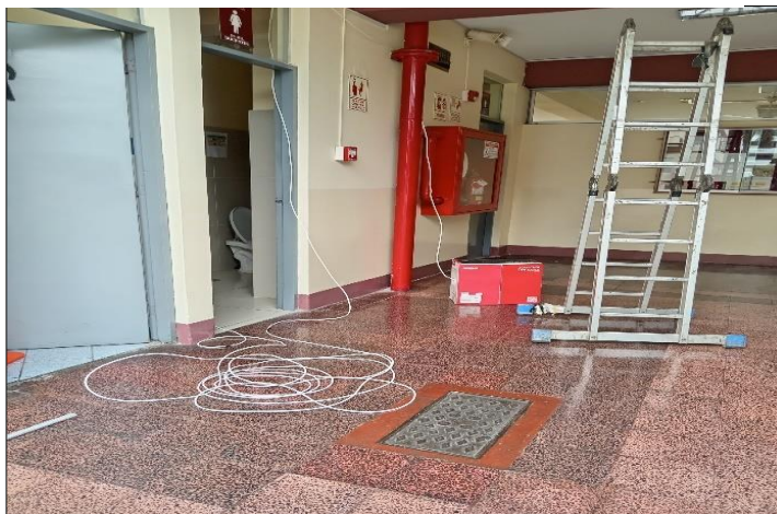
Figura 34 Cableado Saliendo de Ducteria
