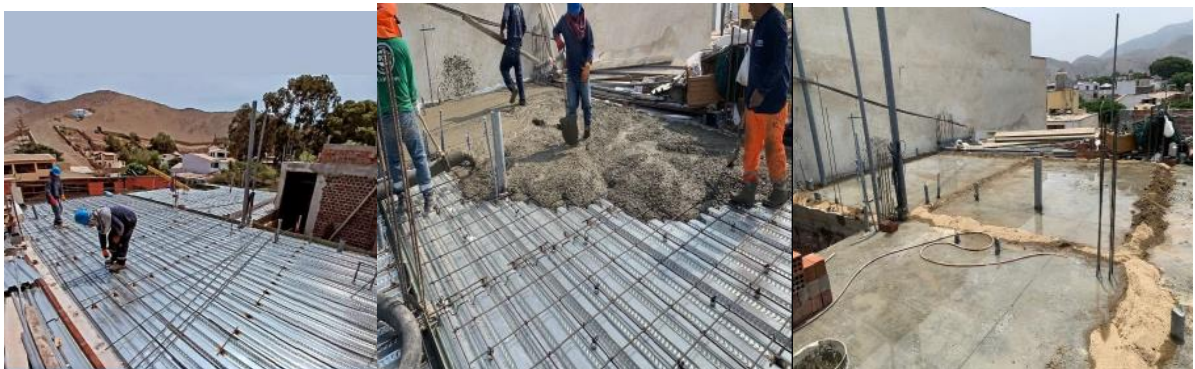
Nota: Instalación, Vaciado y Curado de Losa Colaborante. Recuperado de proyecto vivienda unifamiliar.
