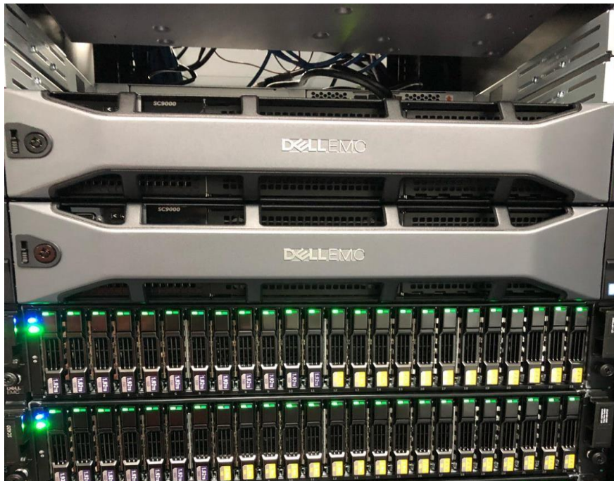
Figura 11- Almacenamiento SAN Fuente: Elaboracion propia
