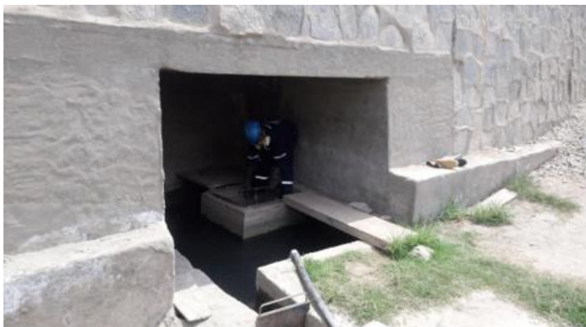
Válvula de captación para San Antonio
