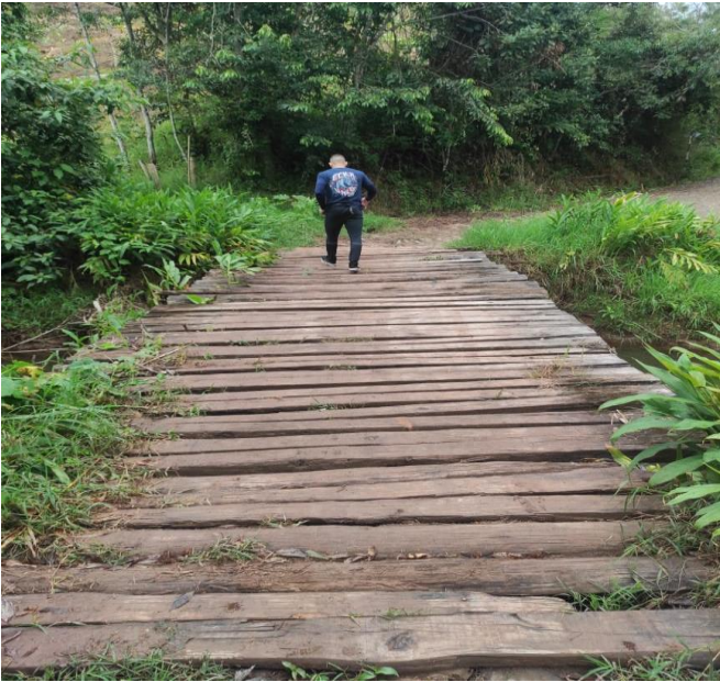
Puentes de madera inestables
